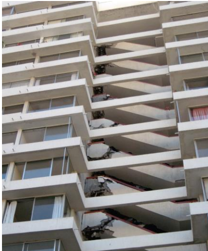
Figura 35. Falla de escaleras de concreto unidas rígidamente a la estructura en el sismo del 2010 en Chile Fuente: FEMA, 2012
