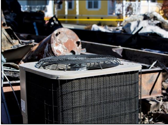
Figura 18. Equipo dañado después de incendio a causa de falla en tuberías por sismo Fuente: FEMA, 2014
