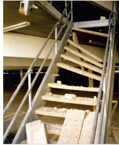
Figura 36. Falla de escalera con peldaños de concreto unidos de manera rígida al acero Fuente: FEMA, 2012
