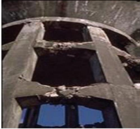
Figura 64. Falla en las vigas de la torre de soporte de un tanque elevado en Chile Fuente: Devadanam, Ratnam, RangaRaju, 2015
