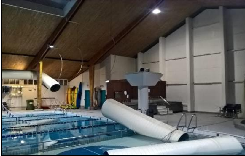
Figura 21. Falla en ductos de aire acondicionado en una piscina en Nueva Zelanda Fuente: stuff.co.nz, 2016
