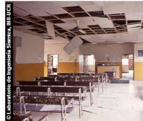
Figura 2. Falla en el cielorraso en la Clínica del Valle de la Estrella
