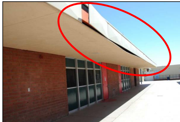
Figura 17. Falla en cielorraso y la precinta en una escuela de California, Estados Unidos Fuente: FEMA, 2010
