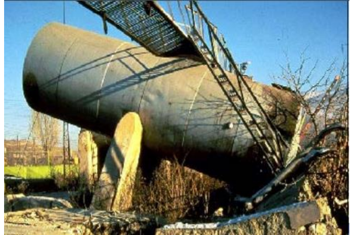
Figura 65. Falla en apoyo de un tanque horizontal Fuente: FEMA, 2013
