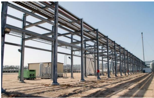
Figura 4. Tuberías elevadas en plataforma Fuente: C.S. Aguirre and Sons, Inc., 2018
