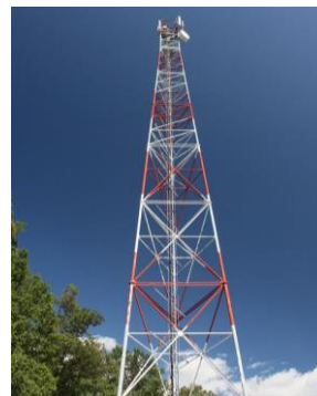
Figura 9. Torre de telecomunicaciones Fuente: www.knoxpages.com, 2018
