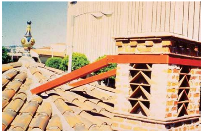
Figura 31. Ejemplo de la colocación de riostras en una chimenea de ladrillo Fuente: FEMA, 2012
