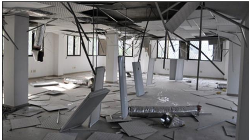
Figura 20. Falla en el cielorraso a causa de un sismo Fuente: weinsteinconstruction.com, 2018
