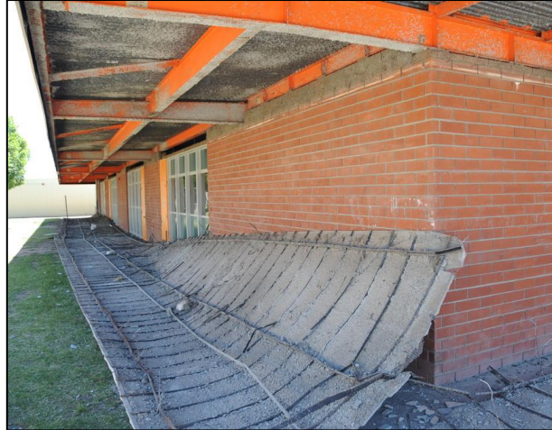
Figura 16. Falla en cielorraso de un pasillo principal en una escuela de California, Estado Unidos Fuente: FEMA, 2010
