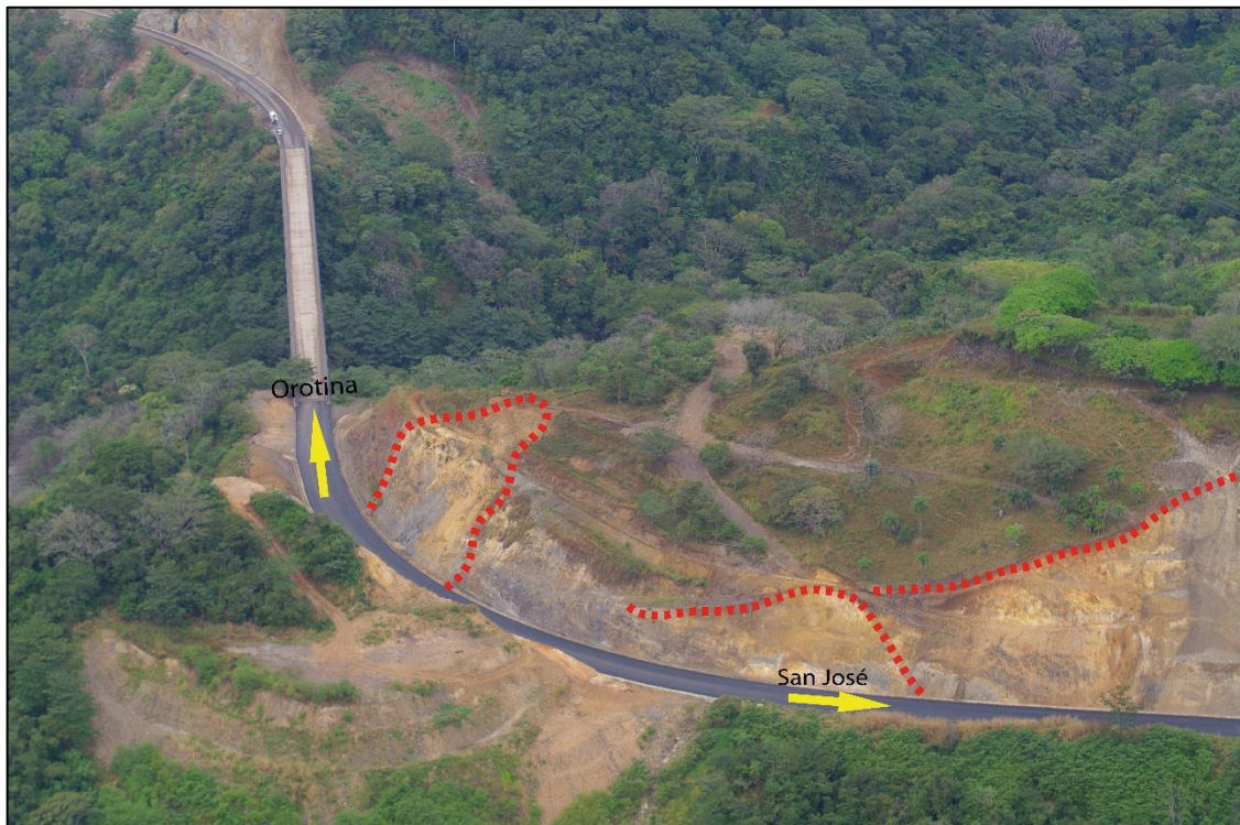
Figura 16. Corte en cajón en el km 45+000, muestra la zona de trabajo previo a ser abierta la carretera. Se observa que para ese momento ya hay desprendimientos de rocas y suelos, producto de los cortes subverticales que se realizaron y que desestabilizaron el terreno. El puente en la imagen es el de la Quebrada Concepción. Imágenes aéreas cortesía de fotosaereascr.com®
