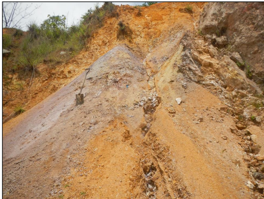
Figura 37. Parte superior del talud, LI. Se observa arcillitización de la tonalidad beige-caffé-naranja-morada , óxidos de hierro y arcillas. Zona de amplia alteración.
