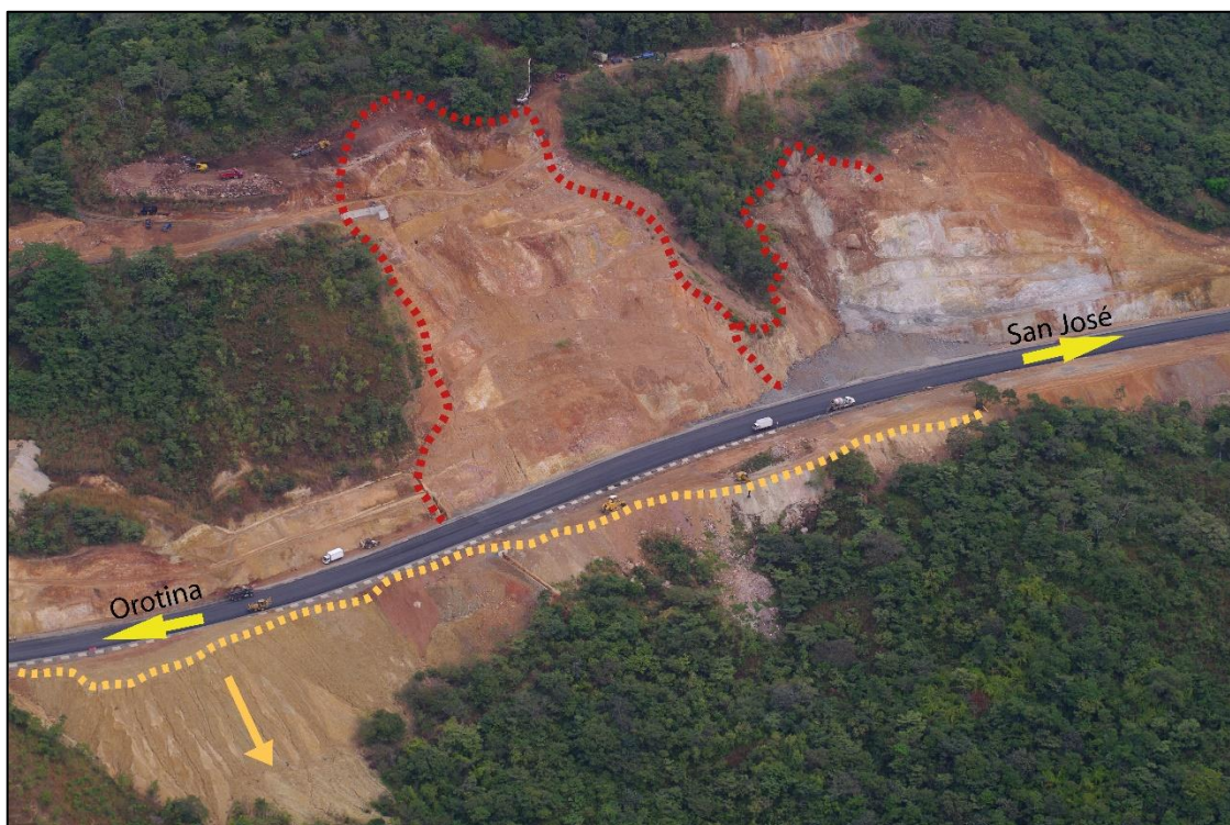
Figura 17. Imagen aérea cortesía de fotosaereascr.com ® en el km 47+000, muestra la zona de trabajo en la etapa de construcción de la carretera. Se observa un deslizamiento en la parte central de la foto. En líneas punteadas rojas, zona con desprendimiento de material, en líneas punteadas amarillas oscuras acumulación del material recolectado el cual fluye talud abajo, como lo indica la flecha. Con flechas amarillas se indica la dirección hacia Orotina al oeste y hacia San José al este.
