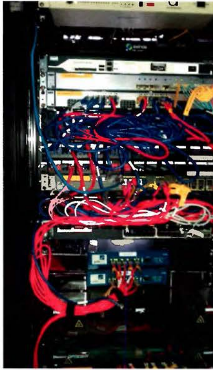
Figura 76. Cuarto de comunicaciones.
