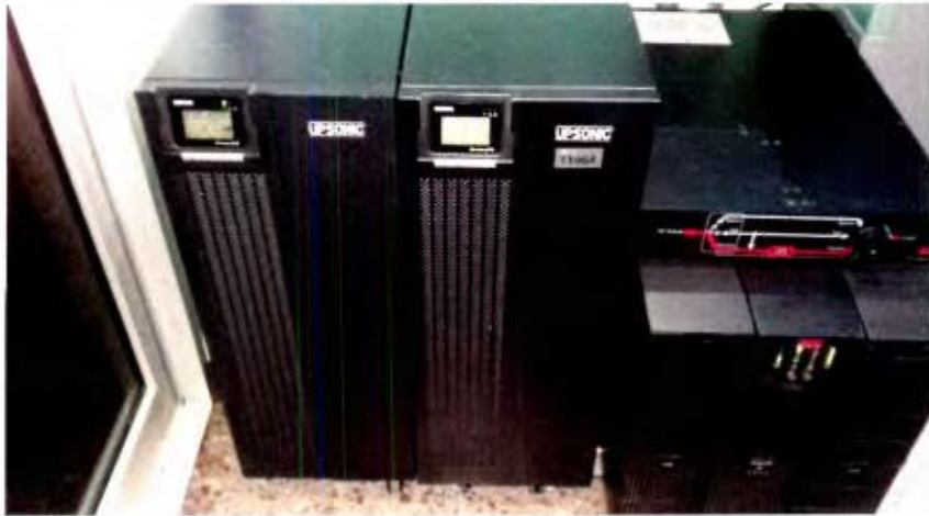
Figura 78. UPS dentro de cuarto de comunicaciones.
