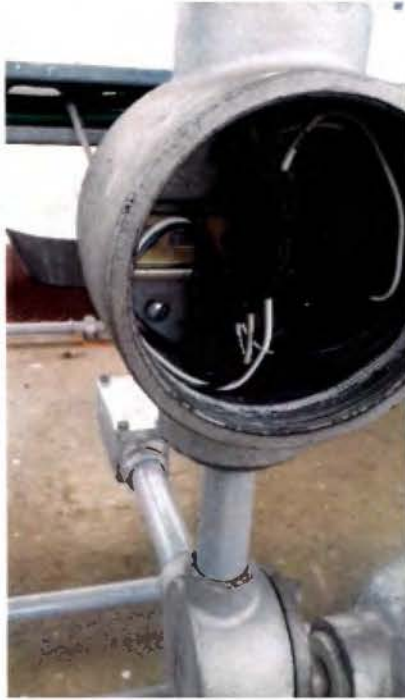
Figura 84. Supresor de transitorios en unidad de control de carga de cisternas.
