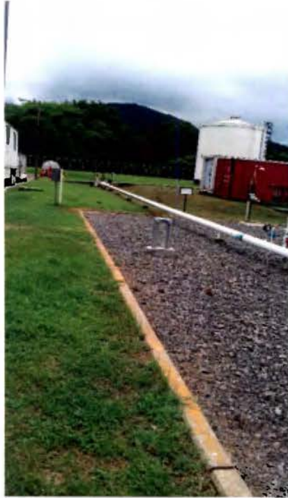
Figura 72. Entrada del poliducto al plantel de Barranca.
