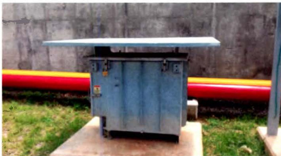
Figura 63. Rectificador de protección catódica.
