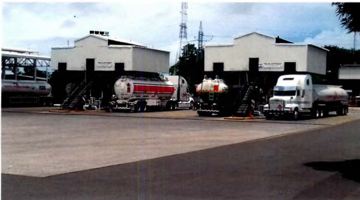
Figura 50. Cargaderos de combustible para cisternas.
