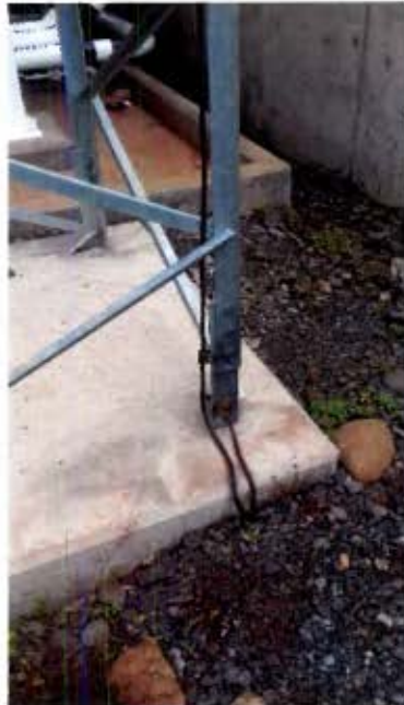
Figura 59. Bajante de pararrayos para catenaria.
