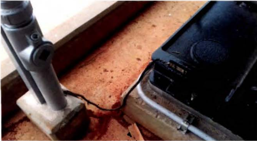
Figura 56. Equipos debidamente aterrizados.
