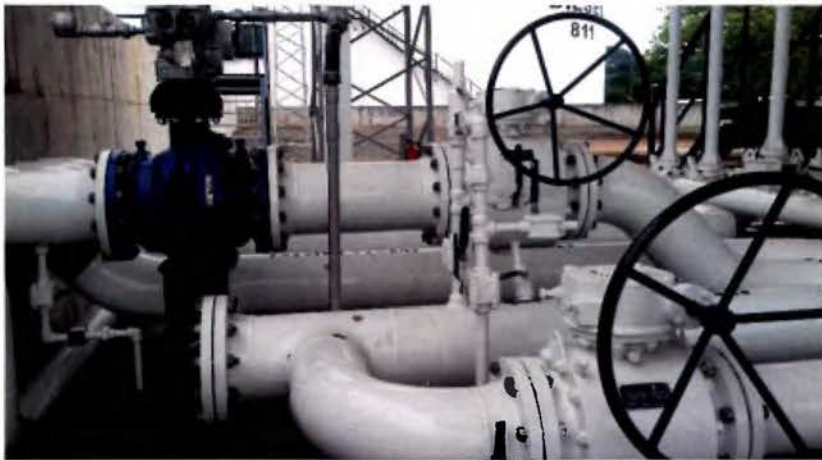
Figura 57. Válvulas y tuberías.
