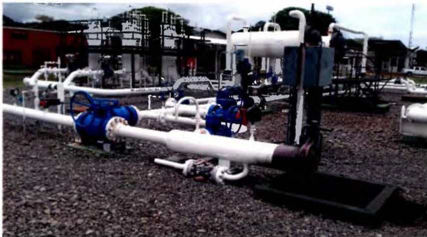
Figura 73. Tuberías para separación de combustibles provenientes del poliducto.
