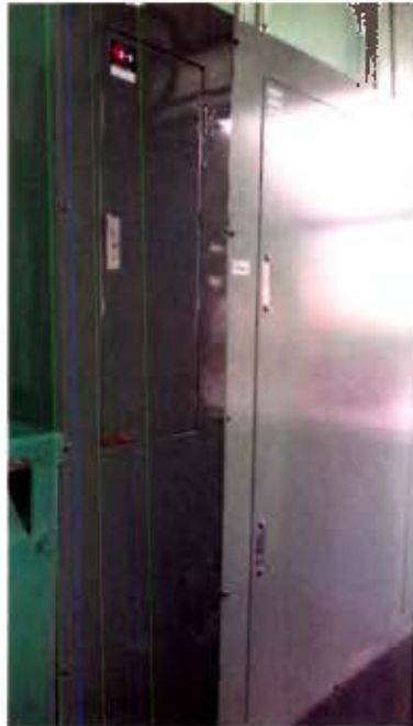
Figura 79. Tablero de distribución eléctrico.
