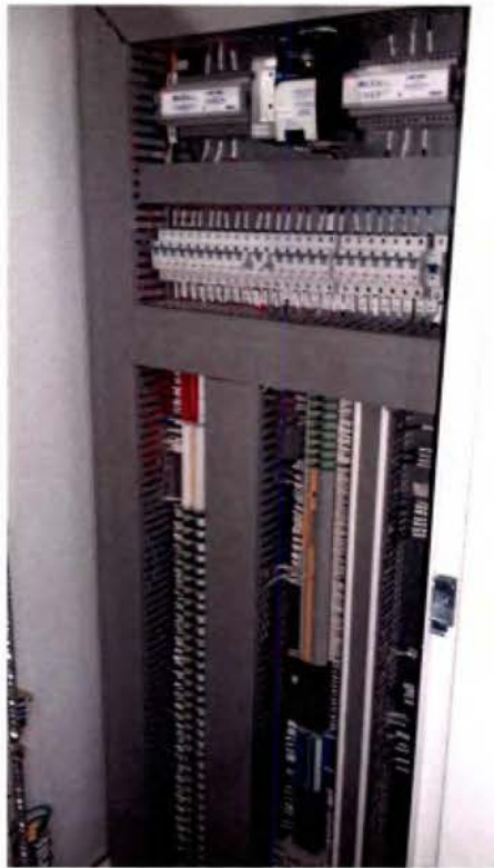
Figura 77. PLC dentro de cuarto de comunicaciones.
