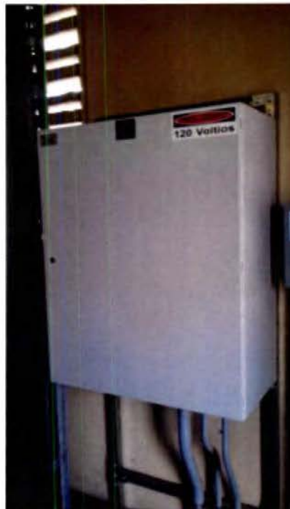
Figura 71. Anexo de PLC.
