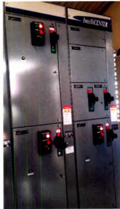
Figura 70. CCM (centro de control de motores).
