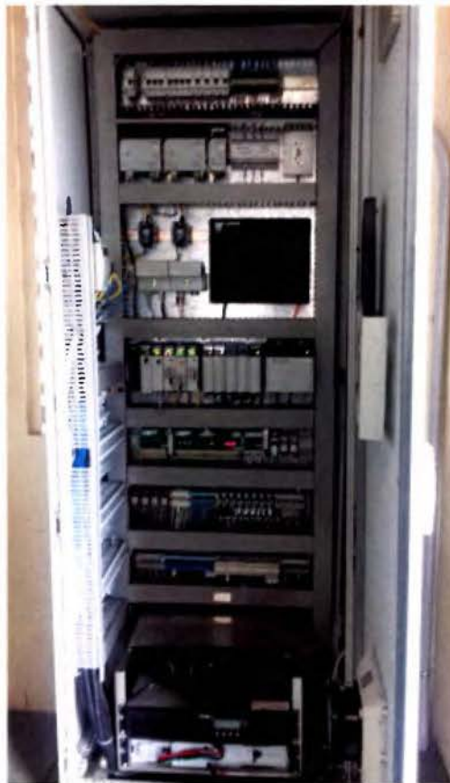
Figura 65. PLC, caja de conexión de fibra óptica, supresor RED y UPS dentro de cuarto de control de motores.
