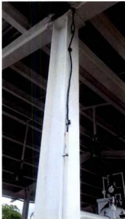
Figura 55. Bajante de pararrayos para punta Franklin.
