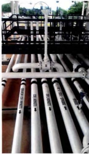
Figura 52. Sistema de tuberías para vaciado y llenado de tanque de combustible JET (para aviones).
