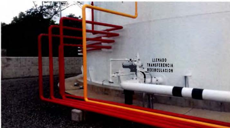
Figura 61. Sistema contra incendios (tubería roja transporta agua, y tubería amarilla transporta espuma).
