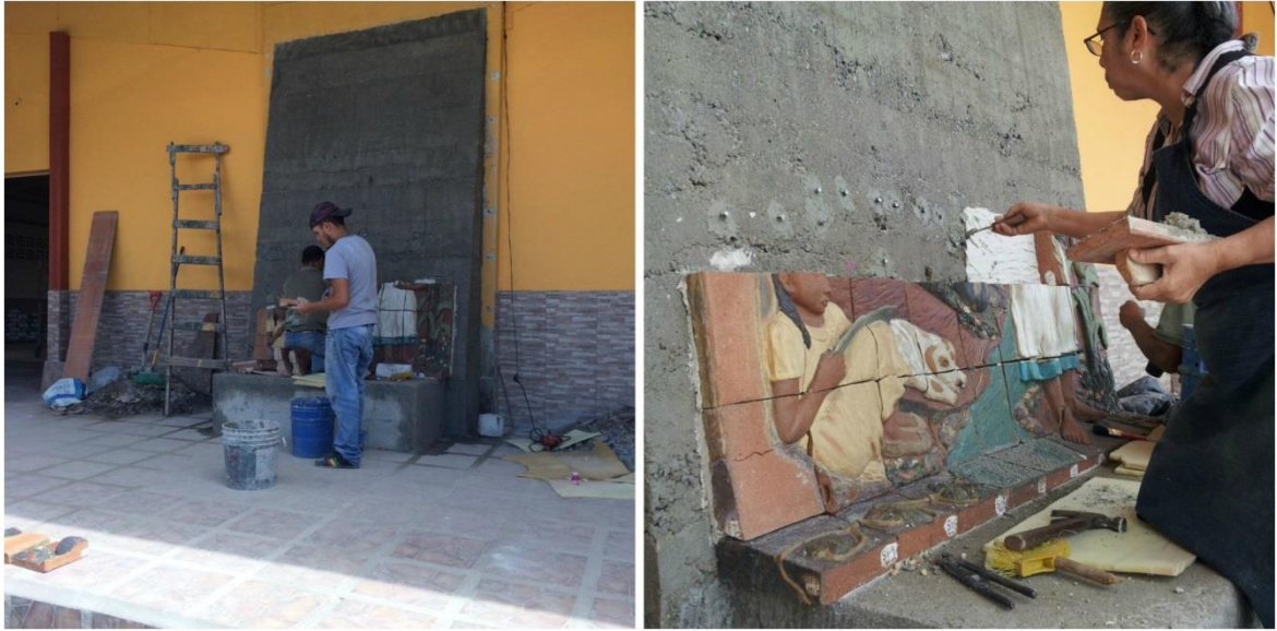
Fotos #48 y #49 Preparación de pared, pegado y enganche de las losetas a la pared Raúl Hidalgo, 2015
