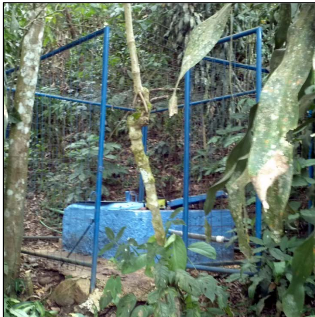
Figura 3.9: Fotografía de la captación de la naciente Arroyo.
