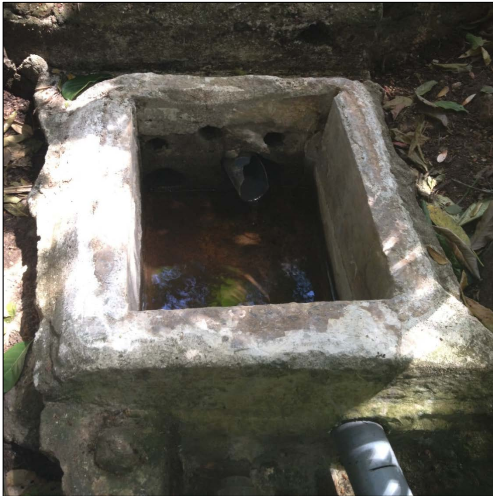
Figura 3.6: Fotografía de la captación en la naciente La Pista.
