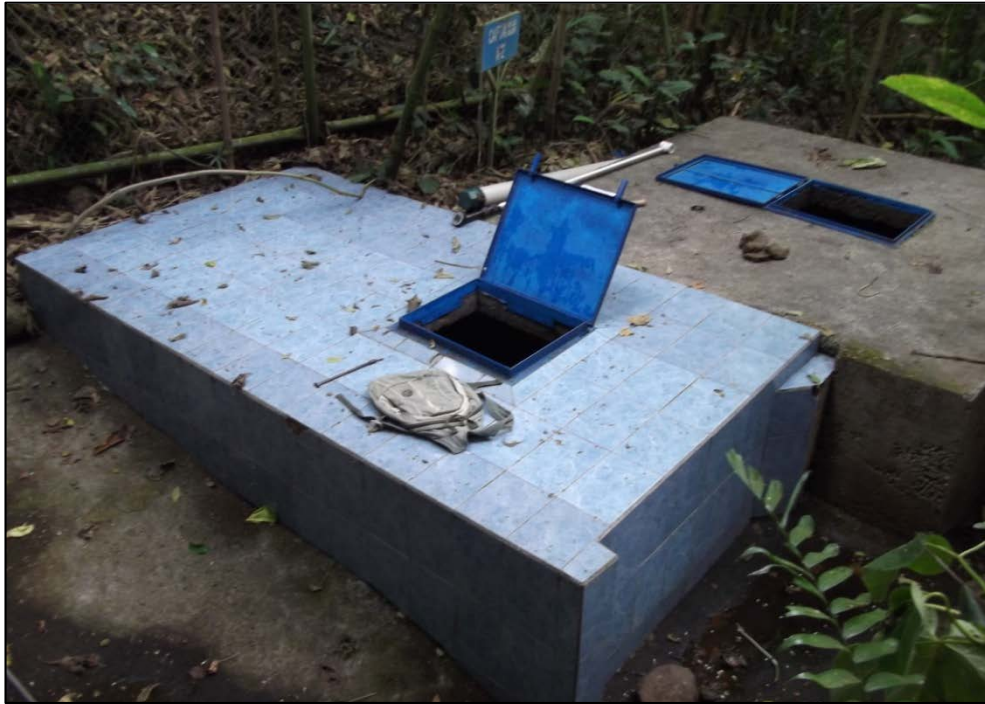
Figura 3.13: Fotografía de la captación en la naciente Captación 2.
