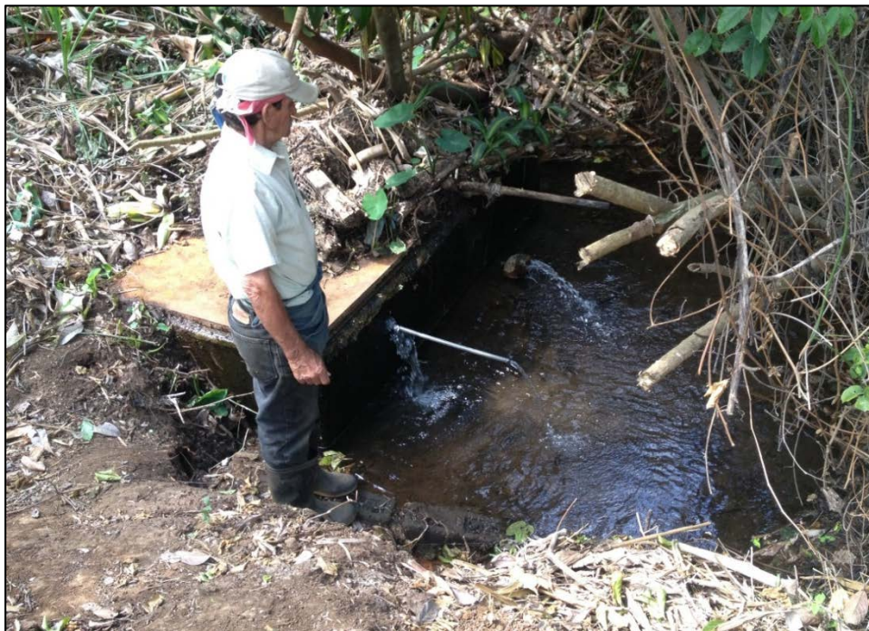
Figura 3.10: Fotografía de la captación en la naciente San Francisco.
