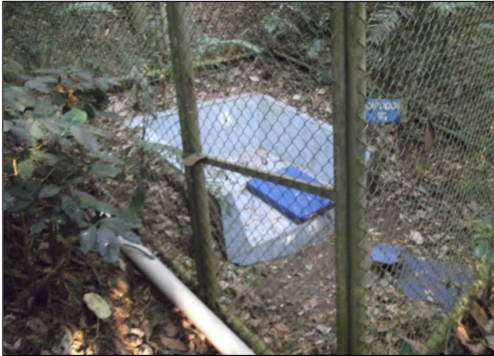
Figura 3.12: Fotografía de la captación en la naciente Captación 1.
