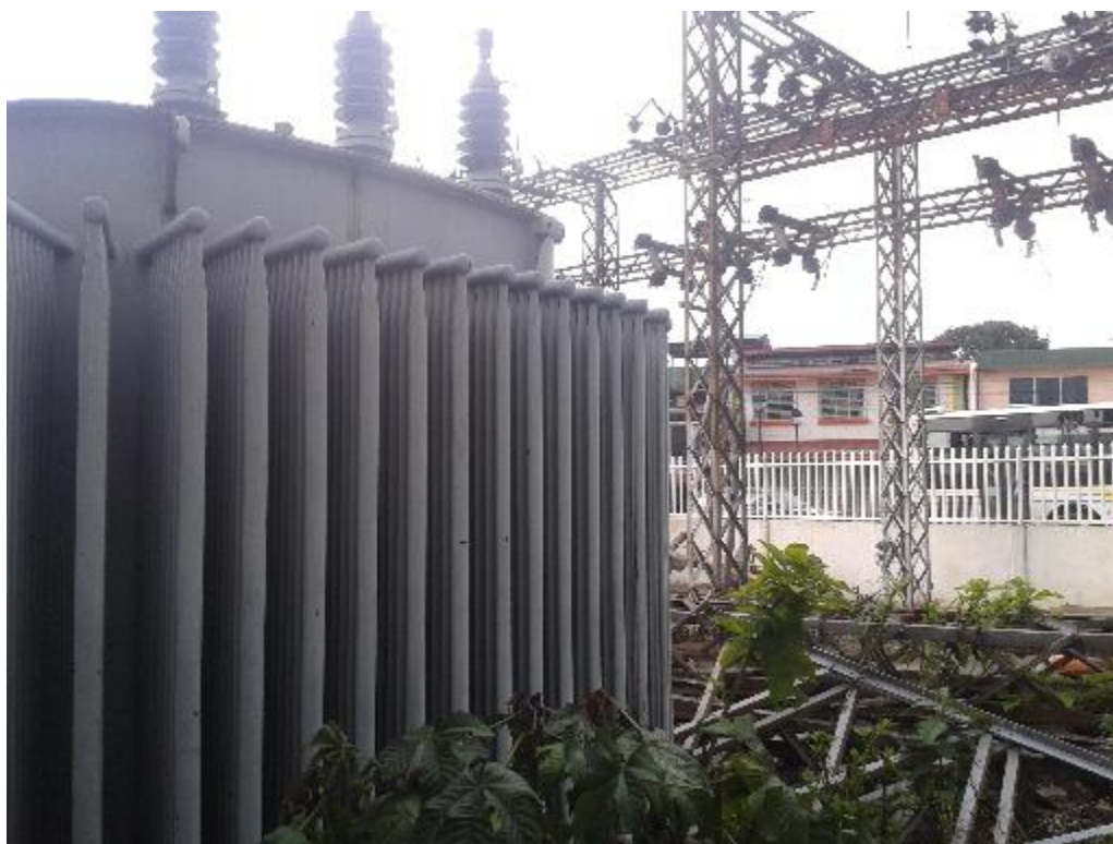
Figura 4.15. Cercanía de los transformadores contaminados con la vía pública
