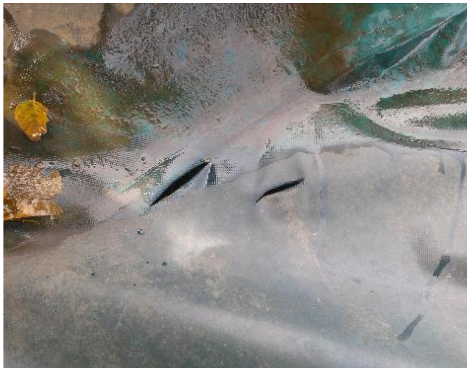
Figura 4.3. Agujeros formados por estancamiento del agua llovida sobre la lona de protección
