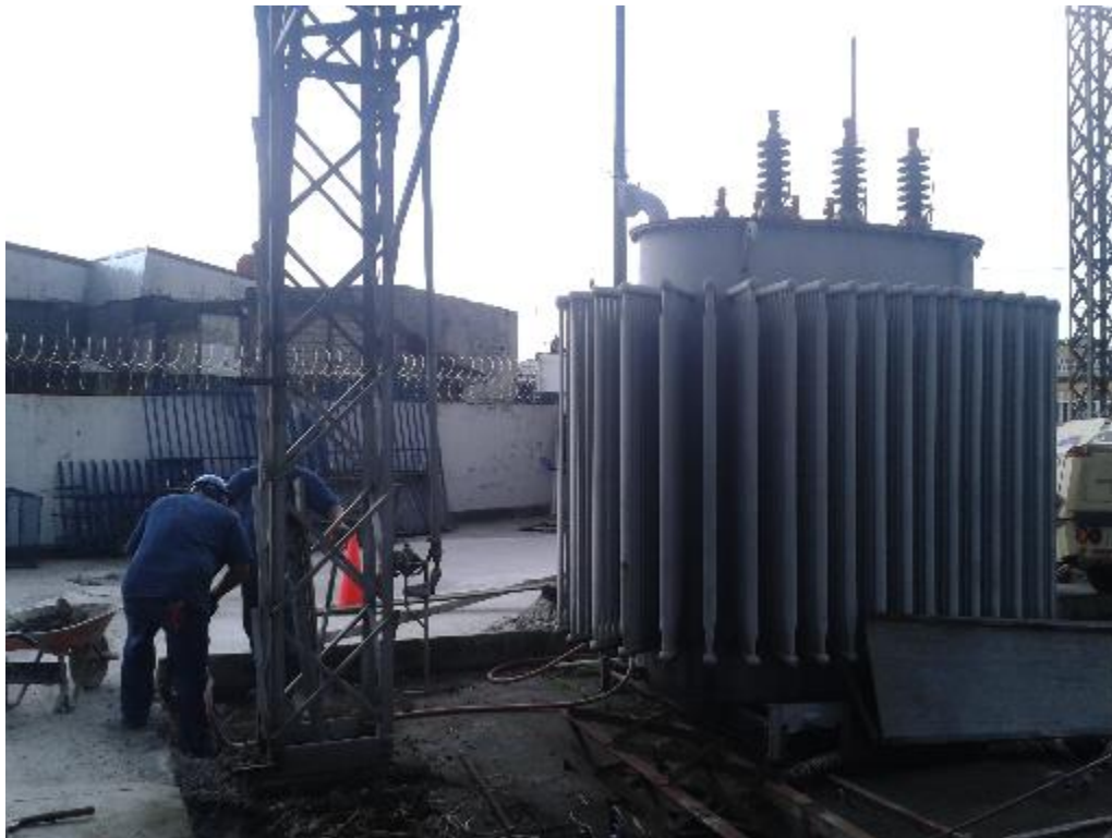
Figura 4.18. Utilización de maquinaria pesada cerca de un transformador contaminado
