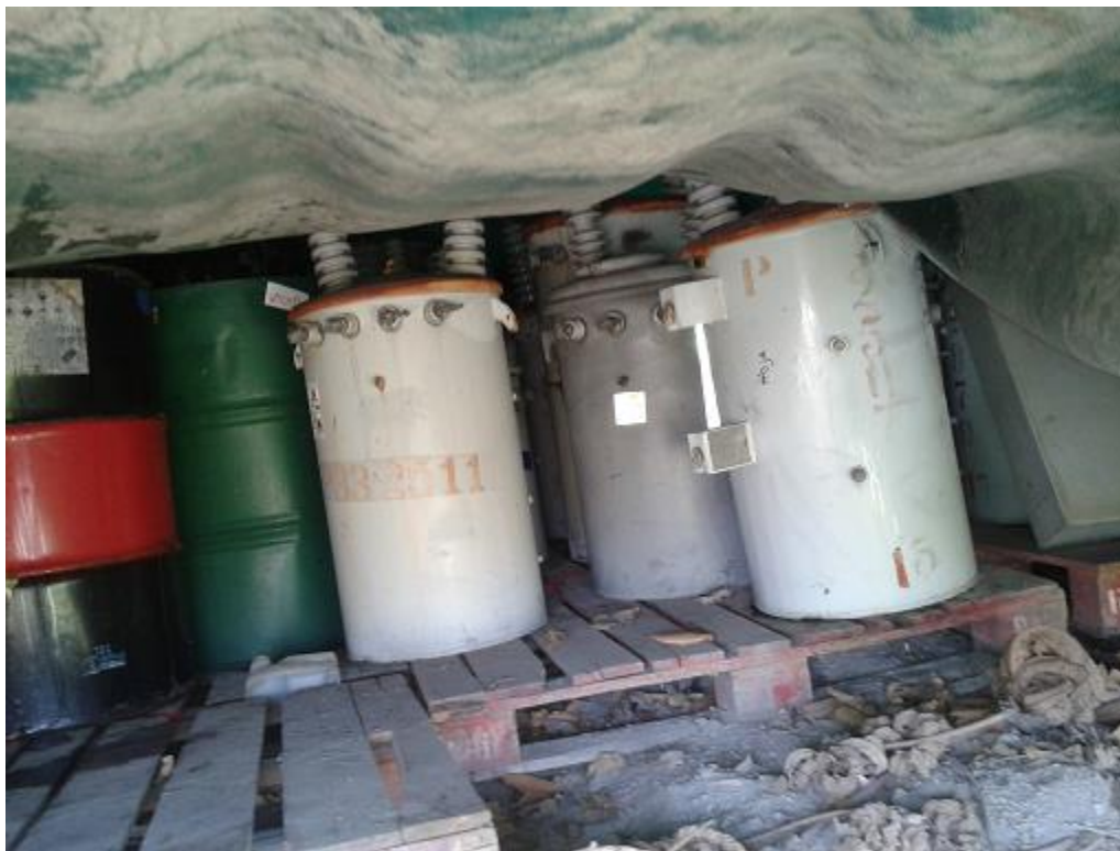
Figura 4.1. Almacenamiento de los transformadores y barriles con aceite contaminado
