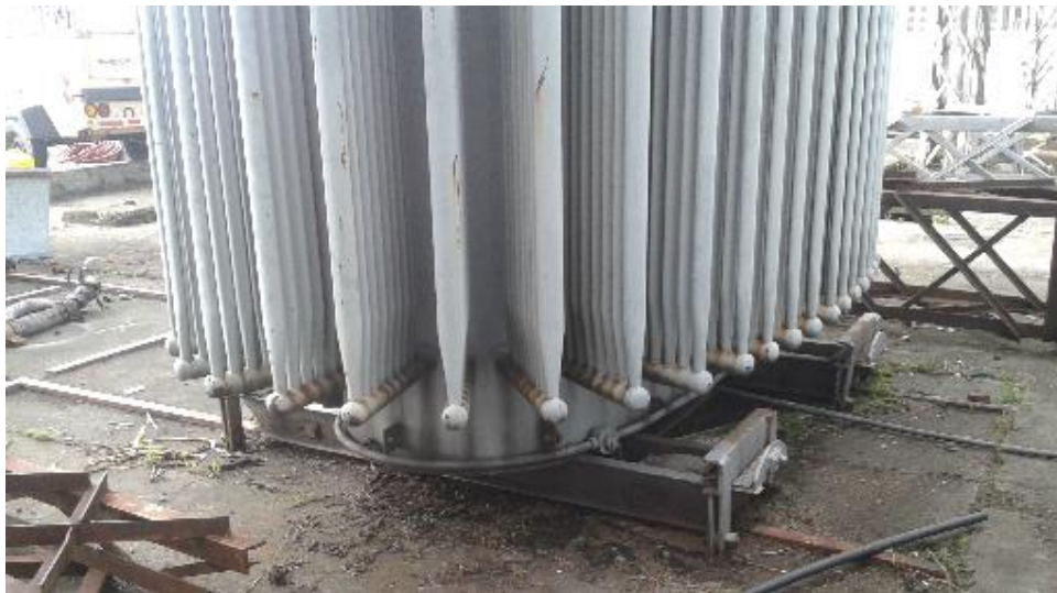
Figura 4.20. Disposición de la base de los transformadores de potencia
