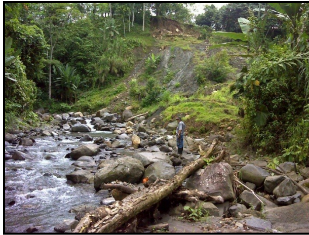
Figura 3.18. Deslizamiento rotacional en lutitas. Coordenadas Este: 542210 Norte: 1110762 Fuente: Michael Calderón Q
