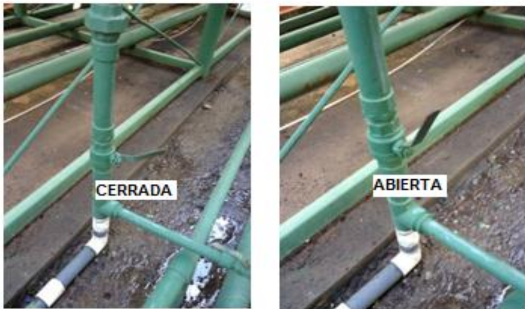
Figura 4.24 Llave de alimentación de agua a clorador
