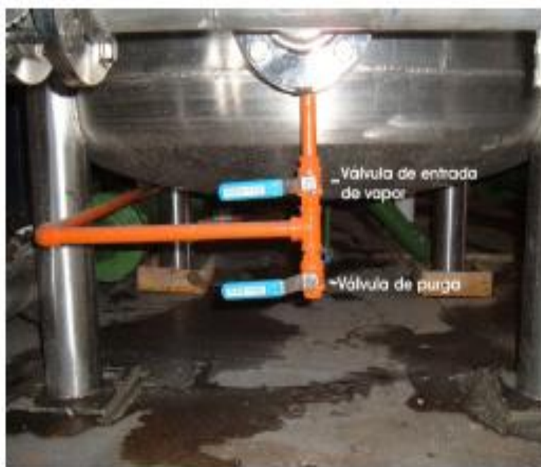
Figura 4.16. Válvulas utilizadas en el saneamiento de los filtros de carbón activado.
