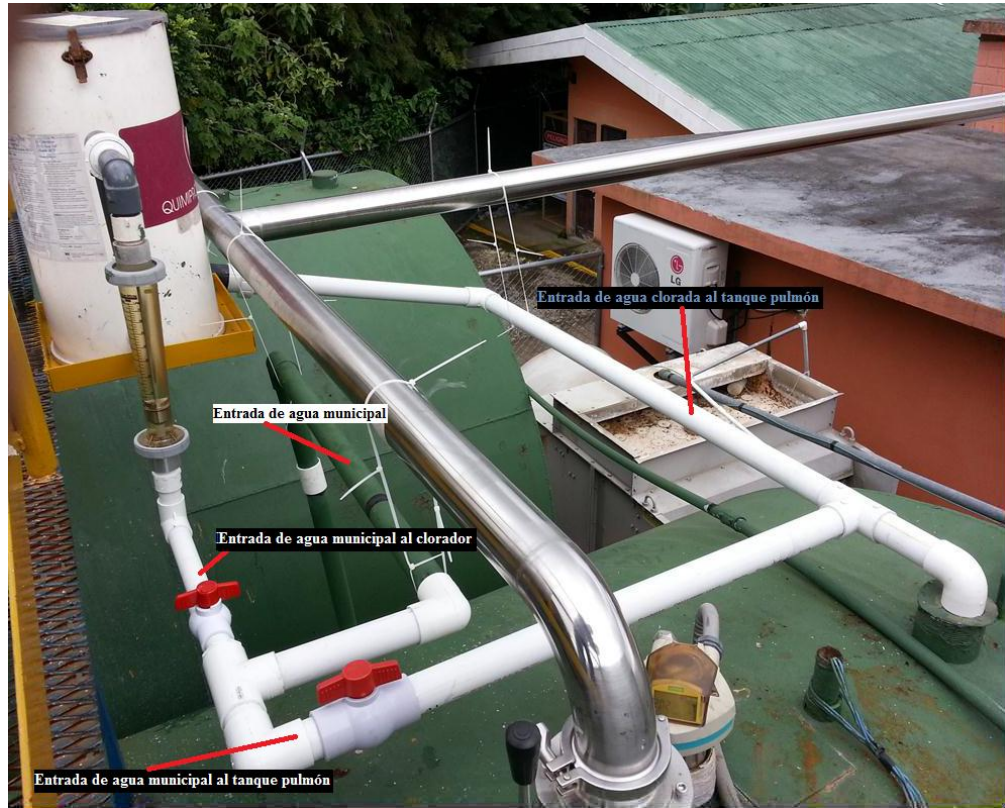
Figura 4.19 Clorador para inundación de red y tuberías conexas.
