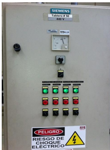
Figura 4.4 Panel de control eléctrico (centro de control)
