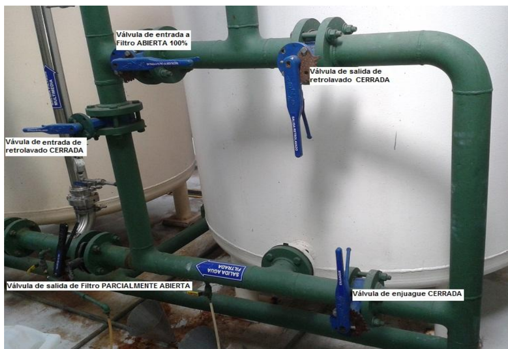
Figura 4.11 Puesta en marcha de filtros multimedia.
