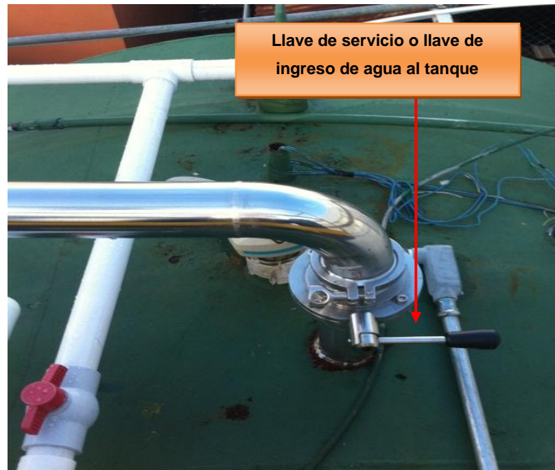
Figura 4.20 Llave de ingreso de agua a tanque pulmón
