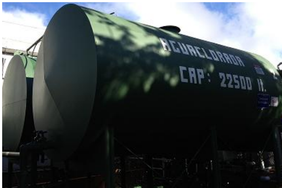
Figura 4.8 Tanques de almacenamiento de agua clorada.
