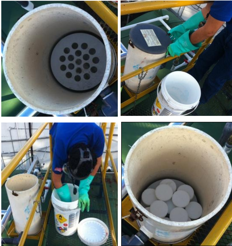
Figura 4.22 Carga de pastillas de desinfectante en el clorador.
