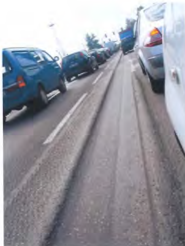
Fig. 2. Aspecto típico de la deformación permanente en el pavimento
