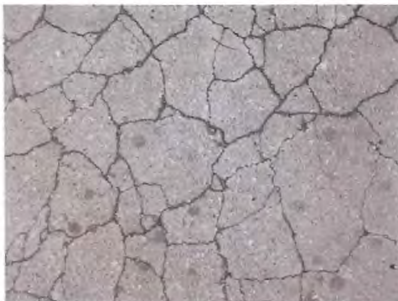
Fig. 4. Aspecto de las grietas en la carpeta asfáltica
