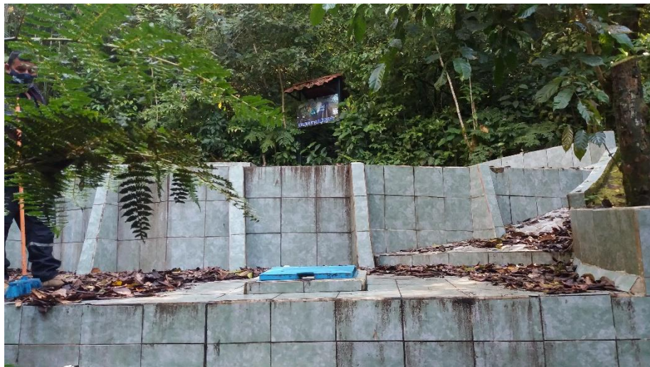
Tanque de captación de la naciente Ansata.
