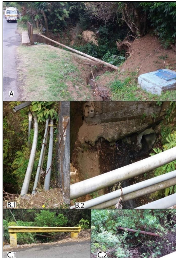
Figura N° 4.54: Tubería de distribución expuesta, ASADA San José de la Montaña. A) sobre ruta 114 (487353 E / 1112186 N). B) calle de acceso al tanque Chaverrí (487282 E / 1111303 N). C) sobre ruta cantonal (486636 E / 1110782 N). (Foto A-B: Hernández, 21 de diciembre del 2021; Foto C: 4 de abril del 2022).
