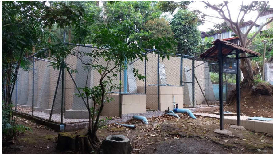
Tanque de almacenamiento La Marta.
