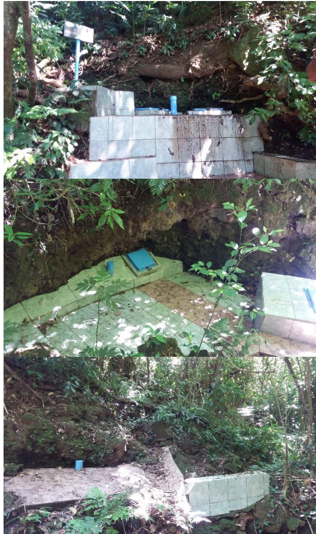
Tanques de captación de las nacientes José Maclovio 1, 2, 3 y 4.
