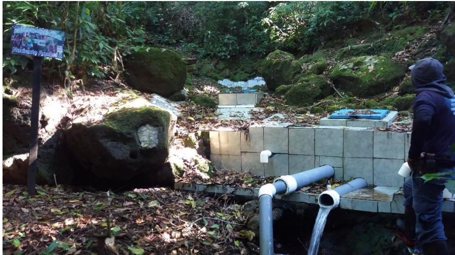
Tanque de captación de la naciente Anabel 2.
