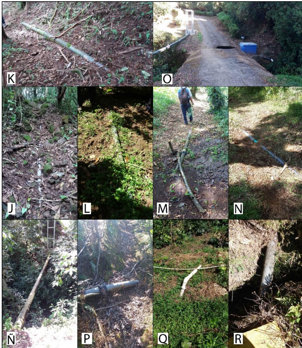
Figura N° 4.53: Zonas de tubería de conducción y distribución expuesta, ASADA San Pedro de Barva. (Foto K-P: Hernández, 2 de diciembre del 2021; Foto Q-R: 2 de febrero del 2022).
