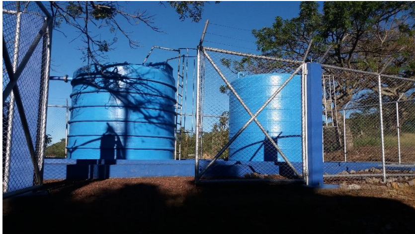
Tanque de almacenamiento Los Gemelos.
