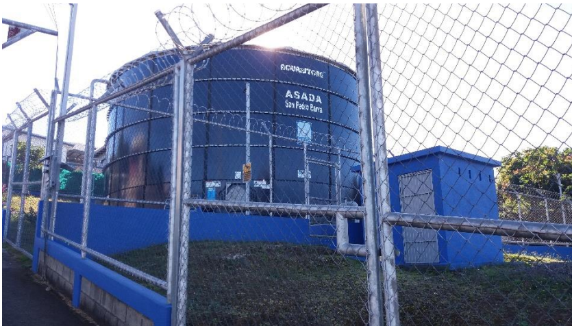
Tanque de almacenamiento San Pedro.
