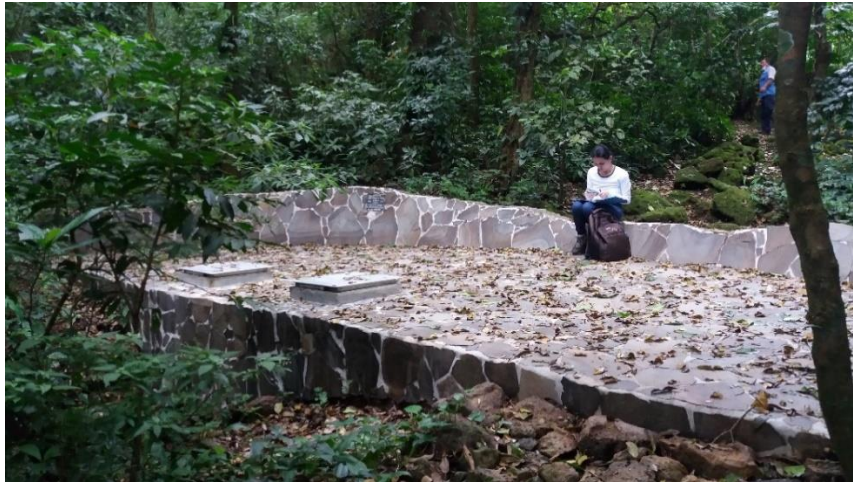
Tanque de captación de la naciente Steinvorth.
