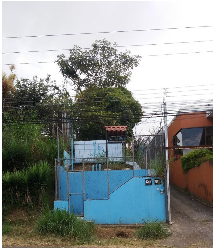
Tanque de almacenamiento Bajito.
