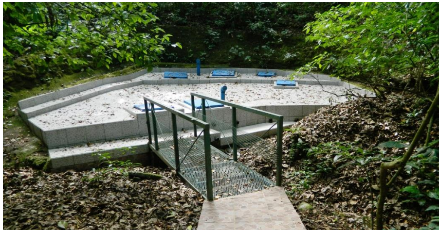
Tanque de captación de la naciente Barbas del Viejo.
