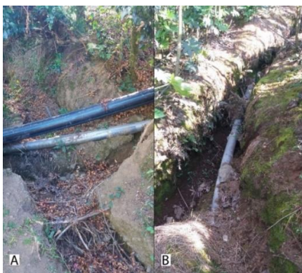
Figura N° 4.50: A) Cambio de tubería PVC a Polietileno. B) Tubería inhabilitada, la cual presentaba trastos expuestos en medio de los cultivos. (Foto: Hernández, 2 de febrero del 2022).
