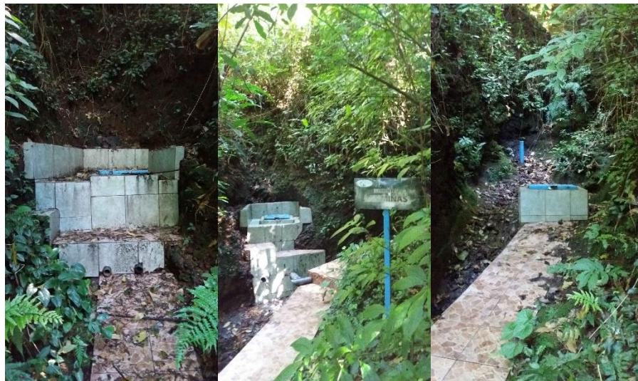
Tanques de captación de las nacientes Las Minas 1, 2 y 3.
