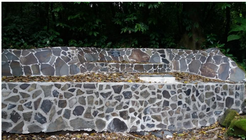
Tanque de captación de la naciente Naranja.
