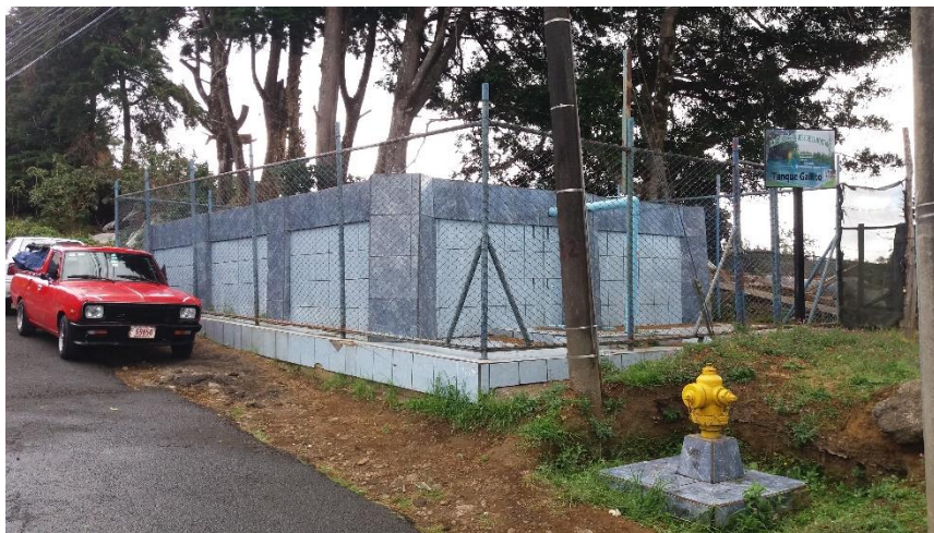
Tanque de almacenamiento Gallito.
