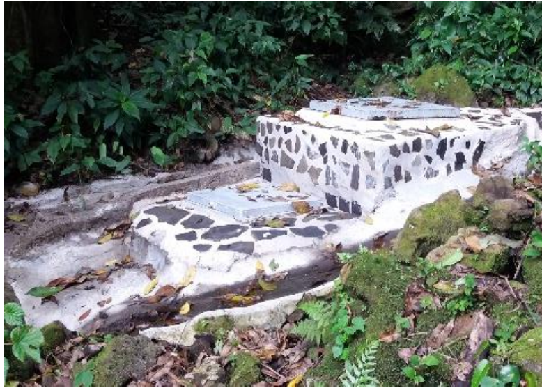
Tanque de captación de la naciente Los Geovannys.
