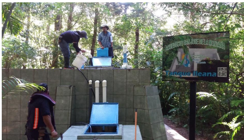
Tanque de almacenamiento Ileana.
