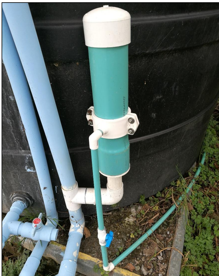
Figura 12. Dispositivo para la disolución de pastillas de hipoclorito de calcio en el tanque La Compostera
