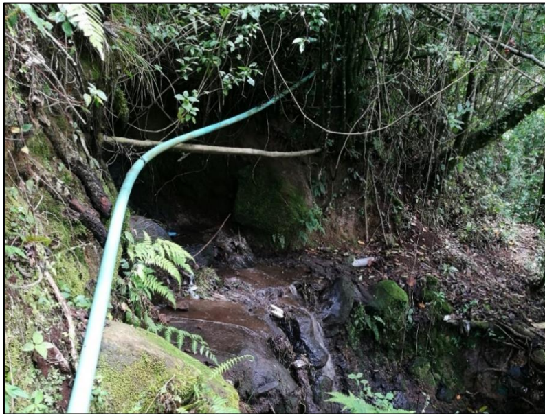
Figura 10. Paso elevado en la línea de conducción entre la naciente La Isla y el tanque La Vuelta
