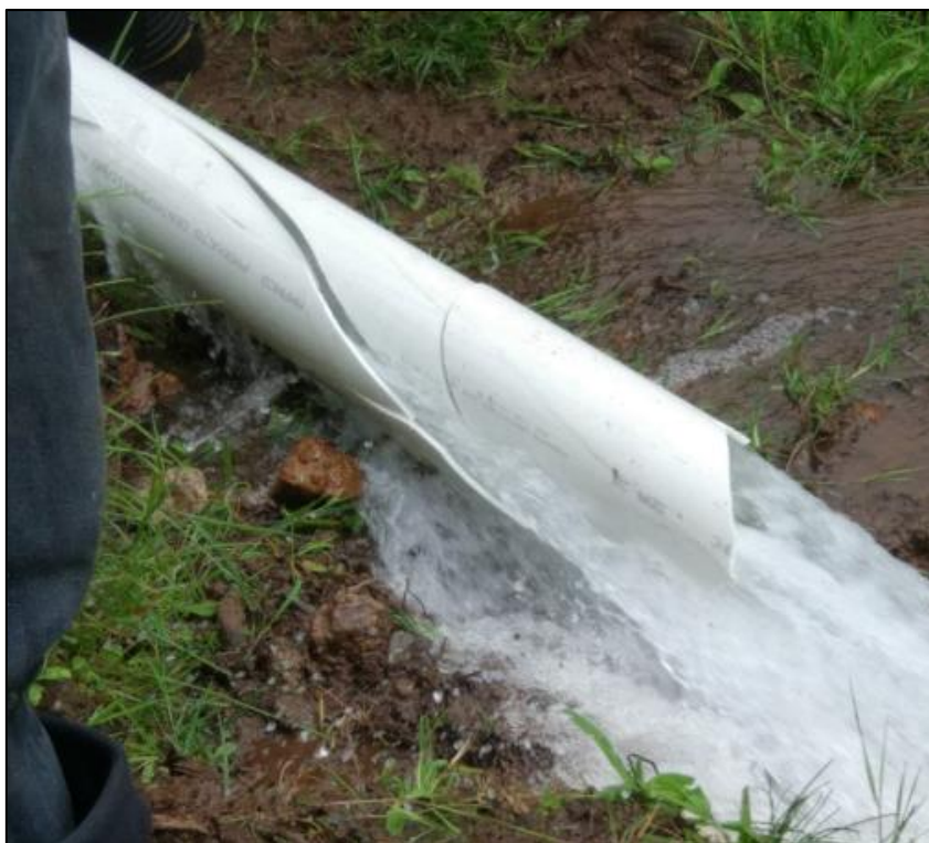
Figura 9. Fotografía de una rotura presentada en una conducción del acueducto de Pacayas
