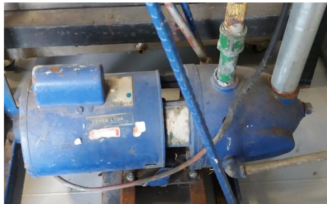
Figura 19. Bomba de la torre de enfriamiento de tiro inducido.
