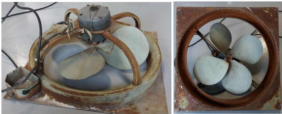
Figura 16. Ventilador de la torre de enfriamiento de tiro inducido.
