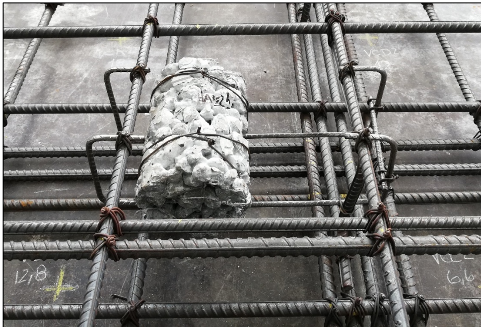
Figura 23. Detalle de la colocación del cilindro de concreto permeable HAE2h utilizando varilla No. 2 y Alambre negro No. 16.
