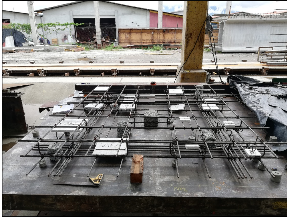
Figura 24. Vista general de defectos en la Losa 1 durante la colocación
