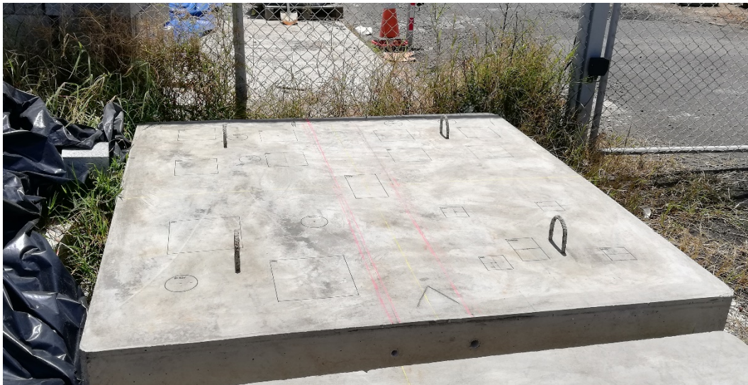
Figura 39. Detalle de la demarcación de defectos sobre la losa 1
