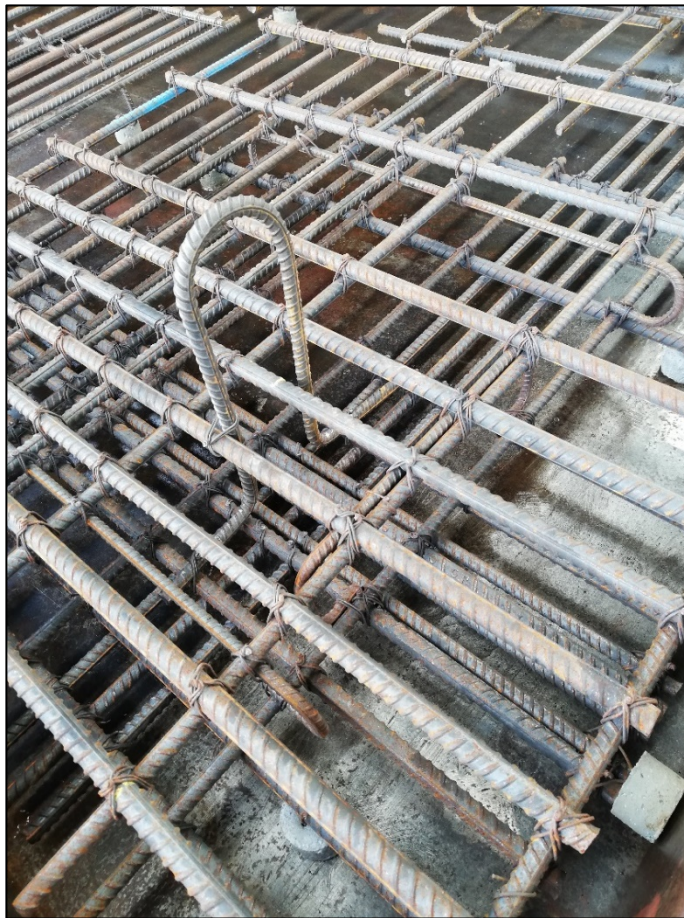
Figura 27. Detalle de la alta densidad de acero de refuerzo en la Losa 2
