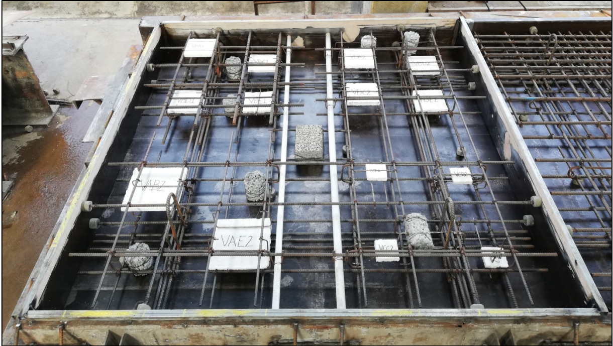
Figura 25. Colocación de la armadura con defectos en la formaleta de la Losa 1
