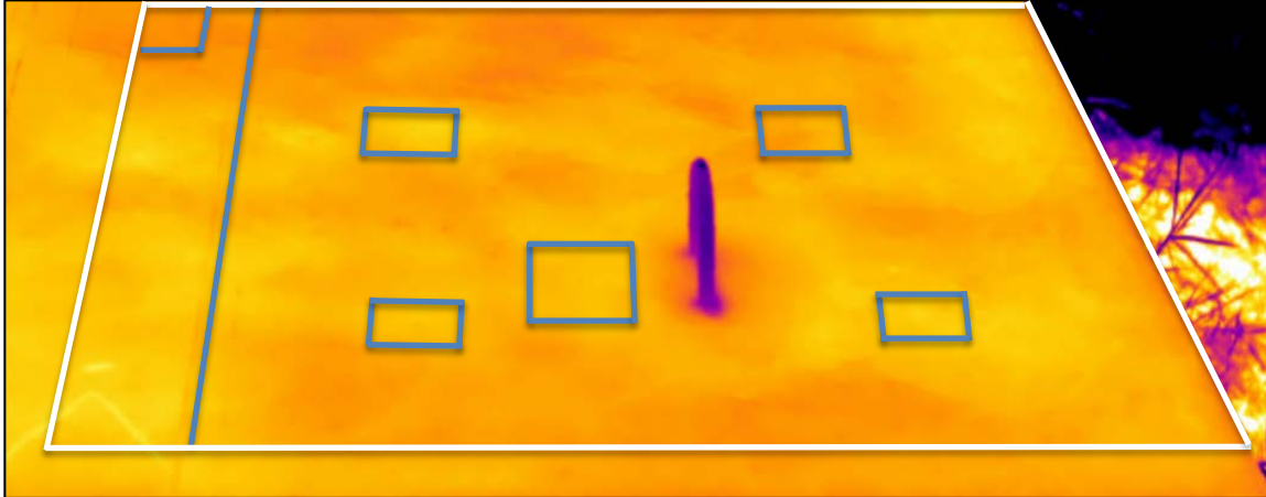
Figura 50. Imagen térmica de la sección D de la Losa 1 ubicando los defectos en la superficie
