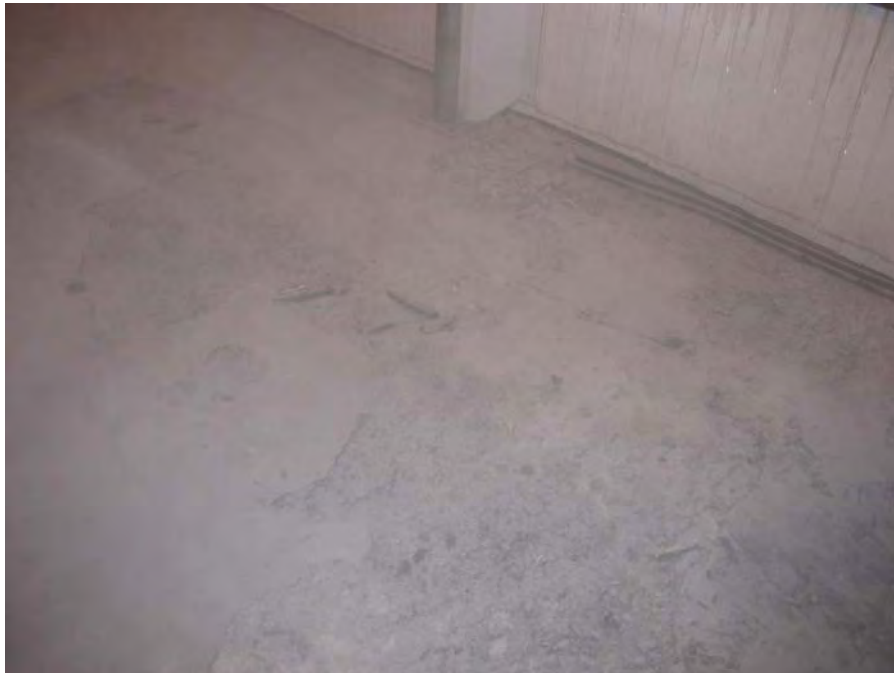
Fotografía 5.7. Losa congelada que dificulta la inspección (04/07/05)
