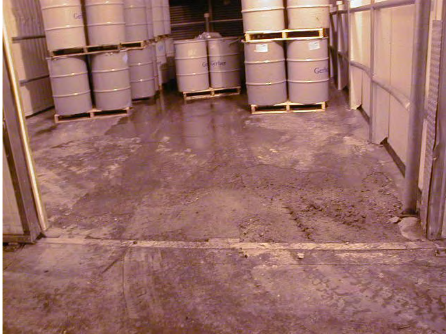
Fotografía 5.3. Pérdida de pasta de cemento en zona de ingreso de montacargas (04/07/05)
