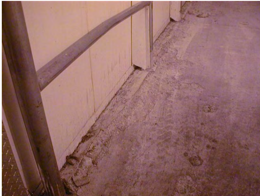
Fotografía 5.4. Área alrededor de paredes delaminada (04/07/05)
