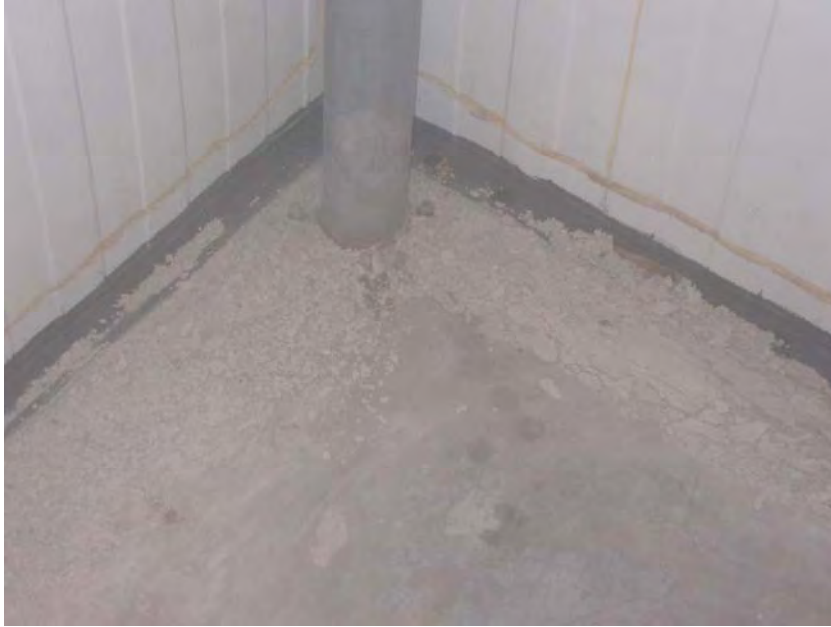
Fotografía 5.5. Curva sanitaria completamente destruida (04/07/05)
