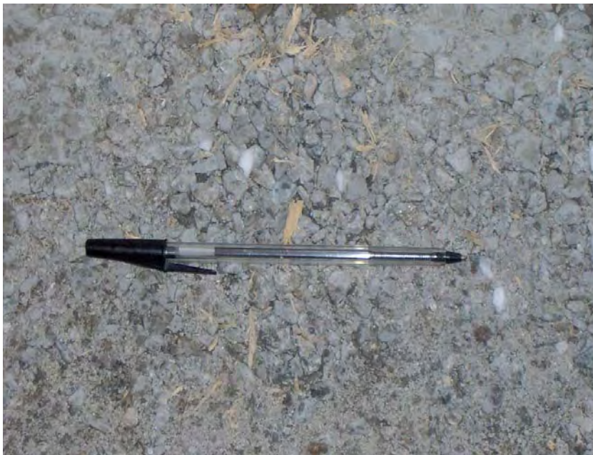
Fotografía 5.6. Delaminación dificulta la limpieza del piso (04/07/05)
