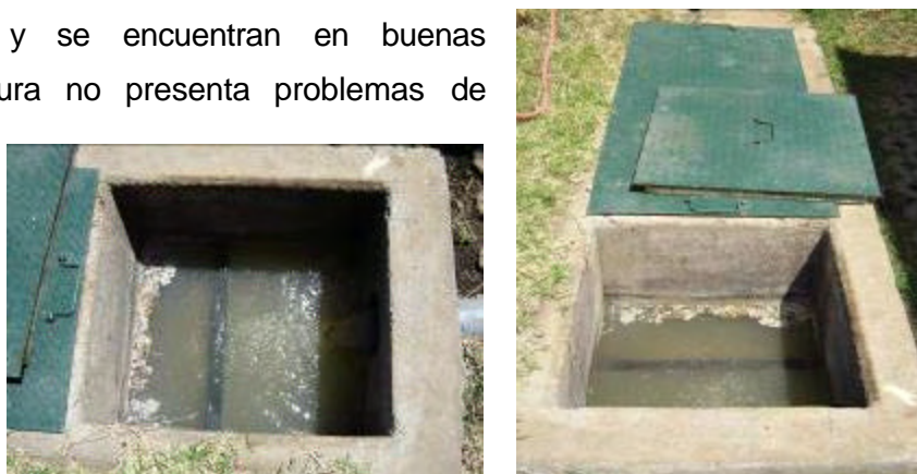
Fotografía 6-4: Trampa de grasas en la PTAR de Bosques de Santa Ana
