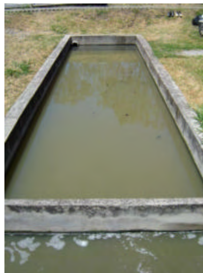
Fotografía 6-10: Sedimentador simple, PTAR de Bosques de Santa Ana
