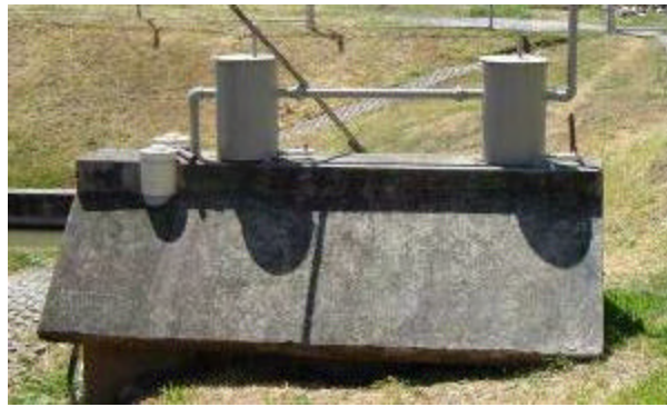
Fotografía 6-8: Digestor Secundario, PTAR de Bosques de Santa Ana
