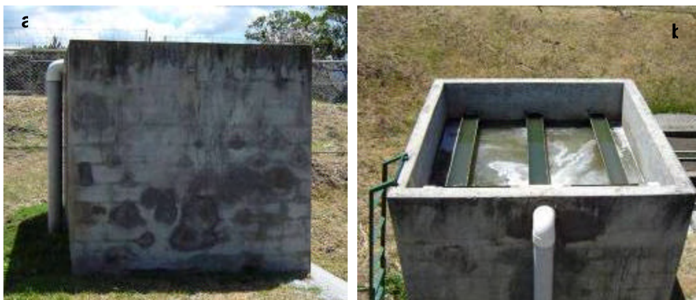
Fotografía 6-9: a) Biofiltro de acabado. b) Sistema de distribución en la parte superior, PTAR de Bosques de Santa Ana
