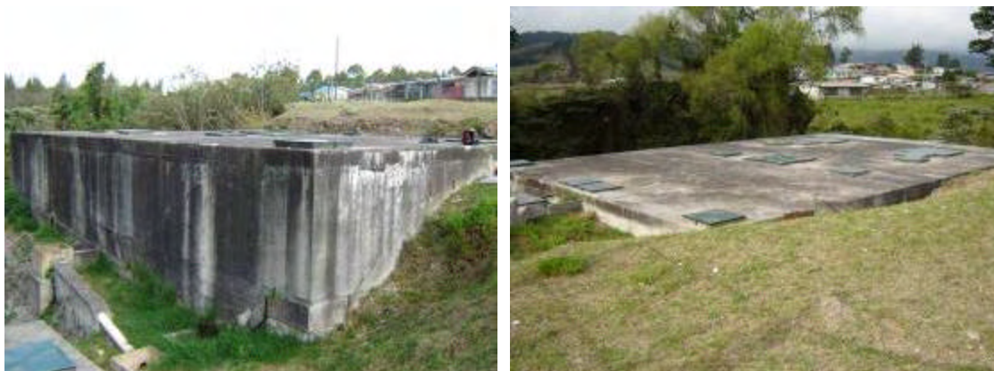
Fotografía 6-19: Planta de Tratamiento de Ciudad de Oro.
