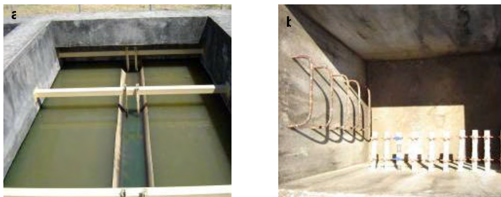
Fotografía 6-7: a) Canaleta de recolección en la parte superior. b) cámara de válvulas de control, PTAR de Bosques de Santa Ana
