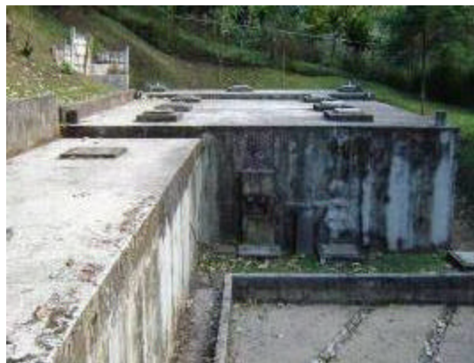
Fotografía 6-14: Vista general de la PTAR, Lomas de Curridabat.
