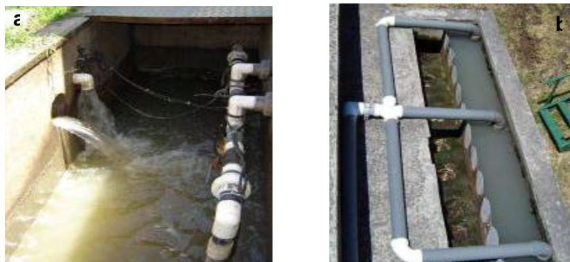
Fotografía 6-5: a) Caja de distribución para el sistema de bombeo. b) Distribución en la parte alta del Reactor, PTAR de Bosques de Santa Ana
