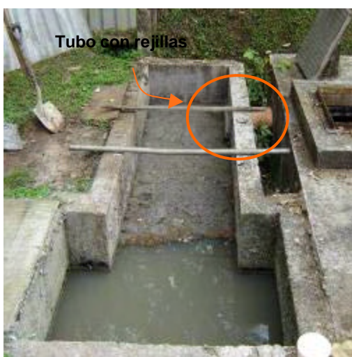
Fotografía 6-16: Caja de entrada, PTAR de Lomas de Curridabat
