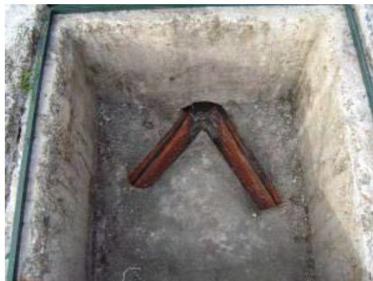
Fotografía 6-26: Caja de distribución, planta de tratamiento de Villas del Sol
