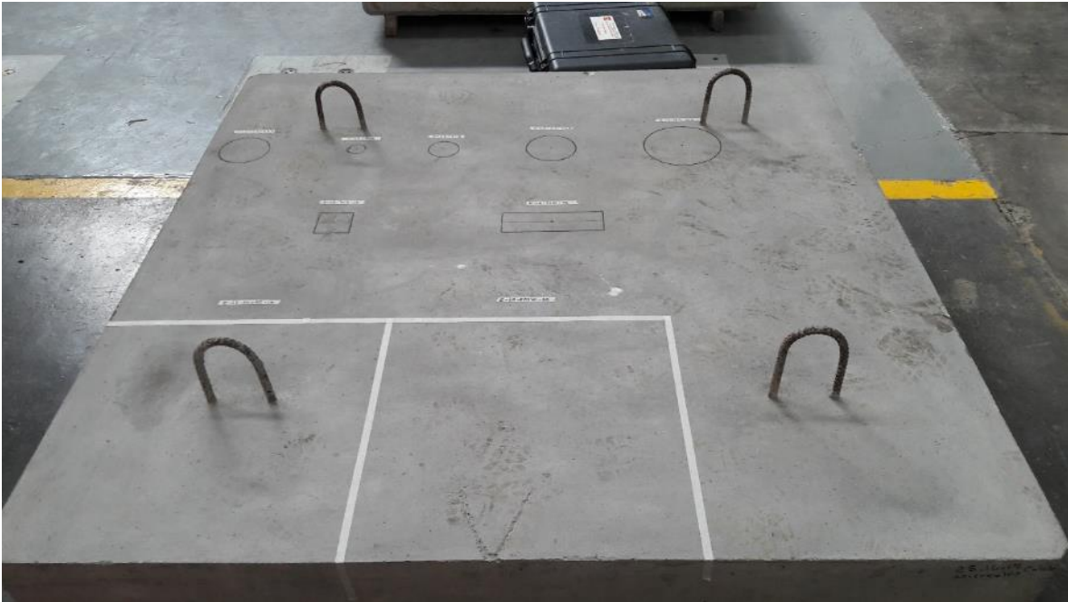
Figura 24. Losa 2 con defectos identificados sobre su superficie
