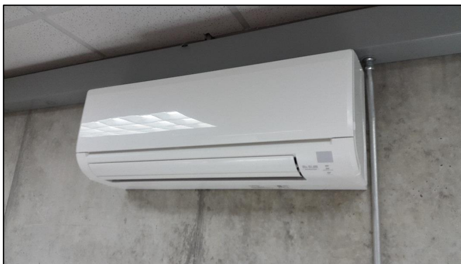
Figura 3. 8. Aire tipo Mini Split instalado en edificio del LanammeUCR
