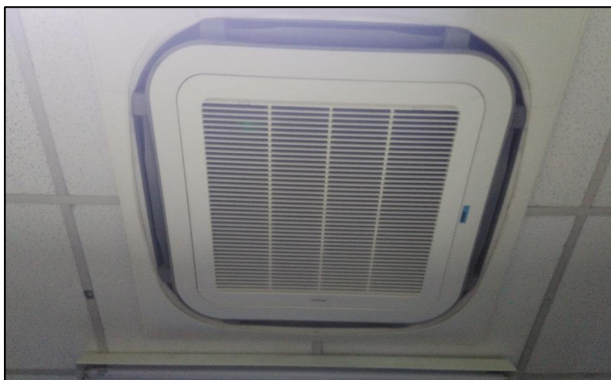
Figura 3. 9. Aire tipo Cassette instalado en edificio del LanammeUCR
