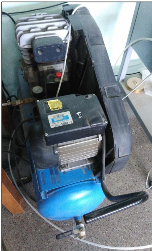
Figura 3. 11. Compresor de aire, modelo 86-D2015/Z, ubicado en el Laboratorio de Geotecnia del LanammeUCR
