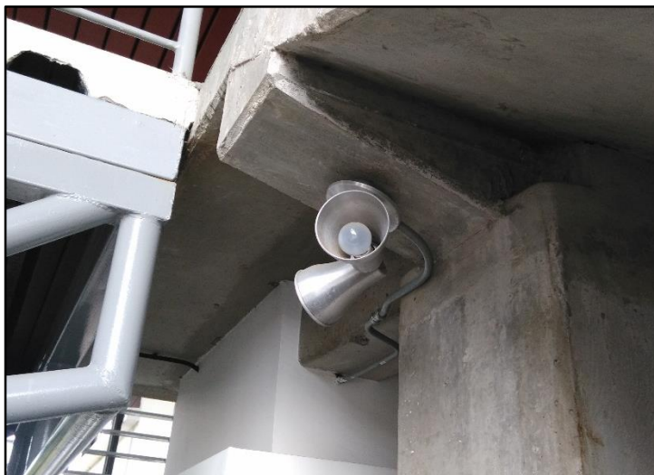
Figura 3. 4. Bombillos incandescentes del edificio del LanammeUCR
