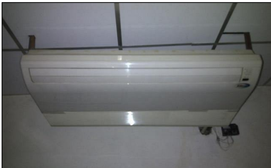
Figura 3. 7. Aire tipo Piso Cielo instalado en edificio del LanammeUCR
