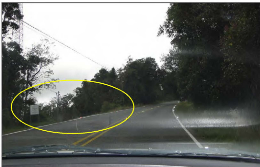
Figura 6.126. Ausencia de barreras de contención en el tramo 30
