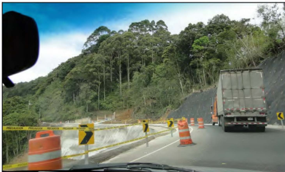
Figura 6.125. Ausencia de barrera de contención en el tramo 11
