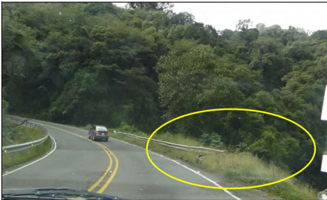
Figura 6.129. Barrera en mal estado en el tramo 56
