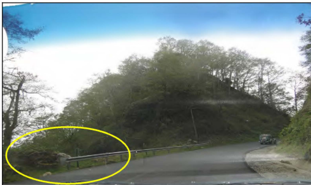
Figura 6.131. Terminal cola de pez en el tramo 83
