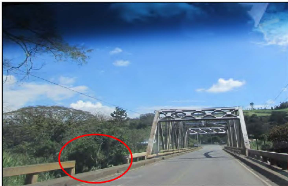
Figura 6.75. Sección del puente sin barrera de contención en el tramo 132 (Enero, 2016)
