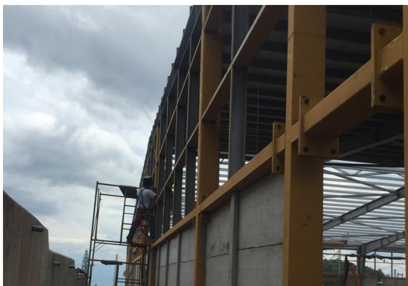
Figura 3.14. Instalación de vigas de amarre soleras transversales proyecto en Puriscal, San José
