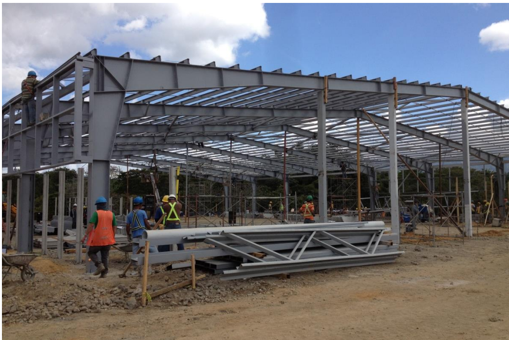
Figura 1.4. Estructura soldada construida en el año 2012 localizada en Desamparados, San José, Costa Rica.
