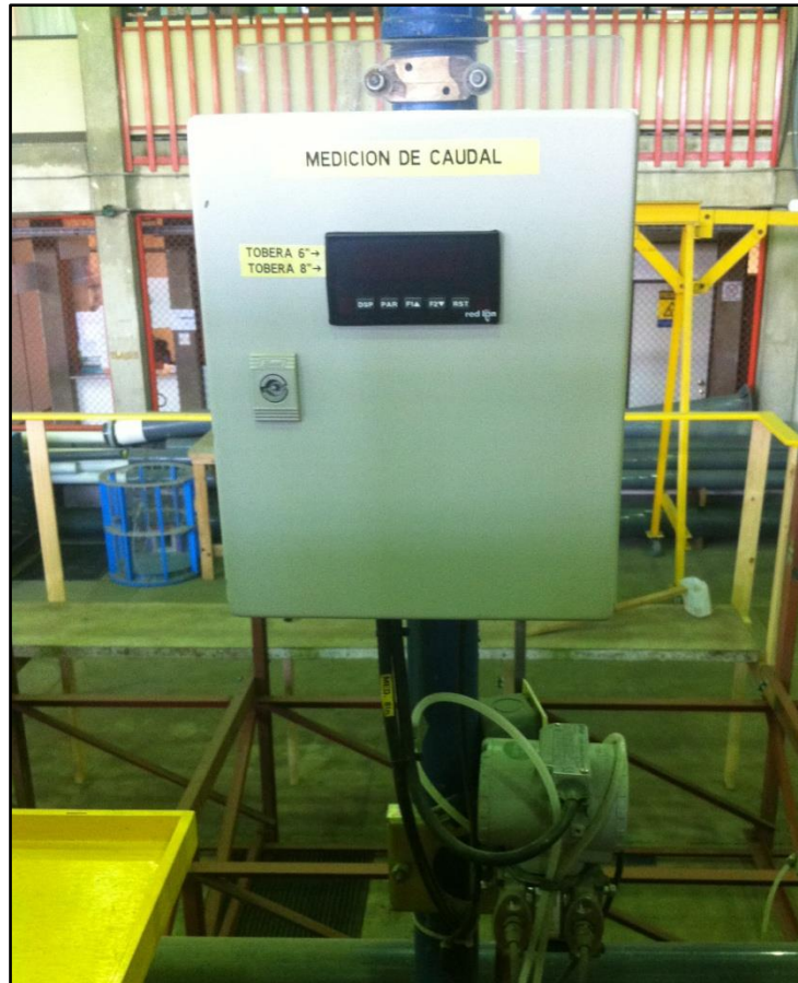
Figura 4.6. Medidor de caudal digital acoplado a tobera de 150 mm
