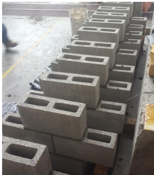
Figura 20. Construcción de cruces de mampostería, ejemplificación de los elementos de madera utilizados
