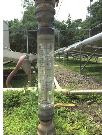
Figura 29. Flujómetro utilizado para medir el caudal de operación de la bomba de recirculación en los colectores solares.
