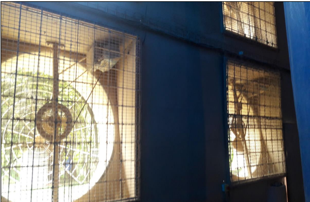
Figura 7. Ventiladores colocados en el fondo de la nave
