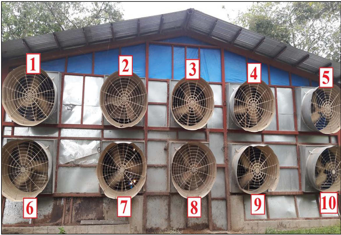
Figura 10. Visualización de los ventiladores y sus debidas posiciones
