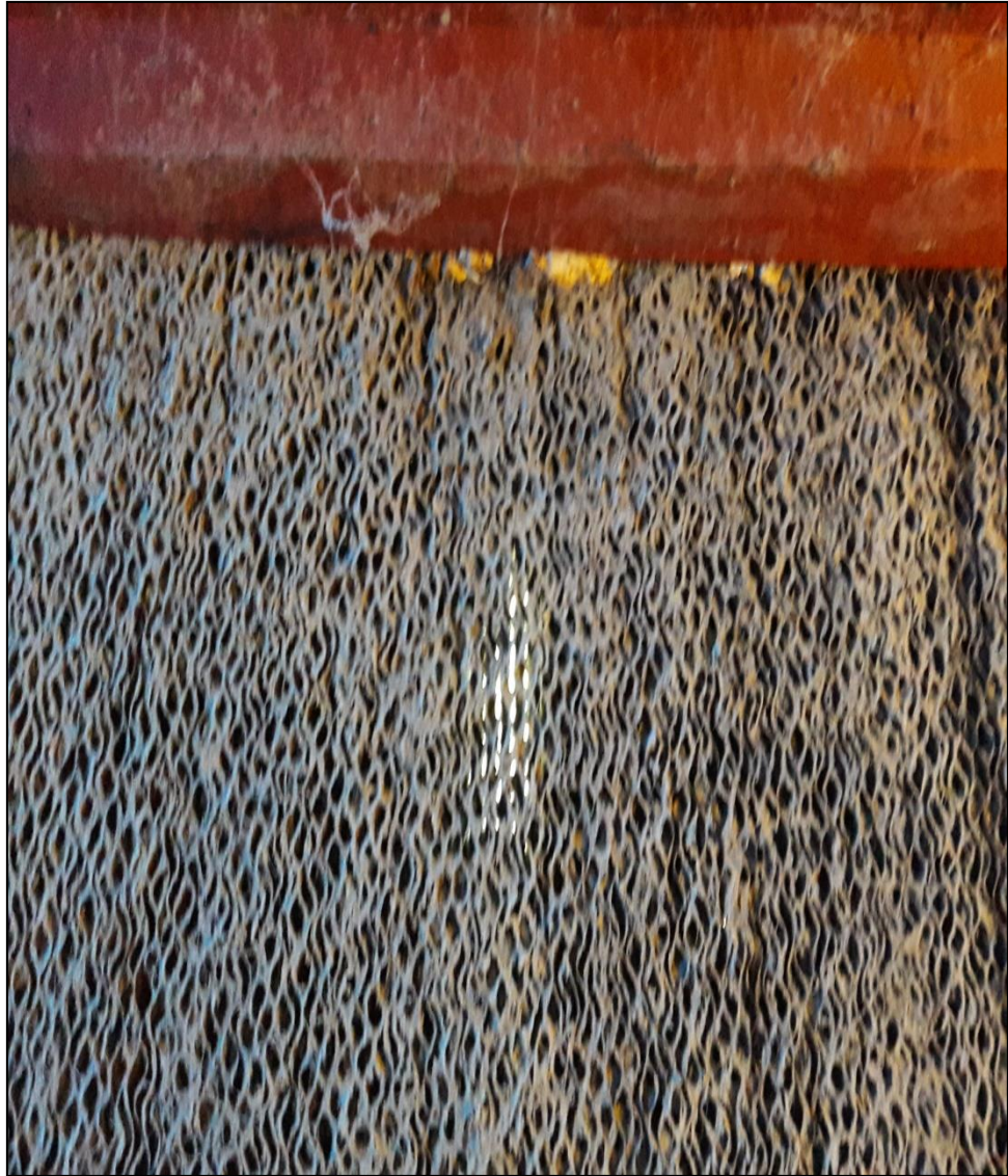
Figura 17. Suciedad en el sistema de enfriamiento
