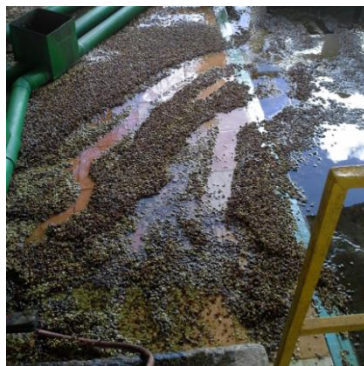
Figura 16. Fuga provocada por obstrucción de las tuberías
