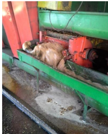
Figura 17. Fugas del canal de despulpador de repaso
