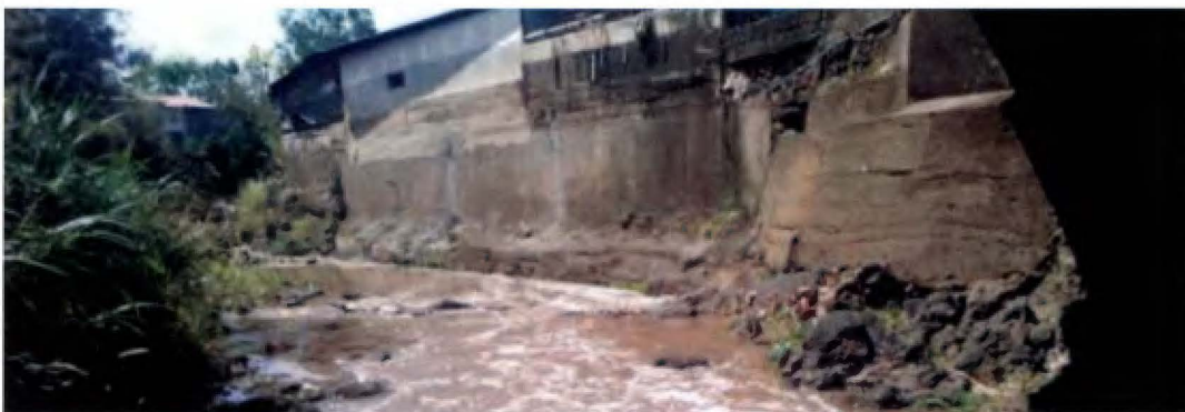
Figura 33. Identificación de tres salidas de agua directas hacia la quebrada en el punto 17, fotografía tomada en la gira de enero.
