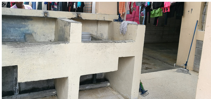
IMAGEN 7.10: Pilas del CAI Vilma Curling FUENTE: ESPINOZA PANIAGUA, K. ; MOYA JIMÉNEZ, M. (2018)
