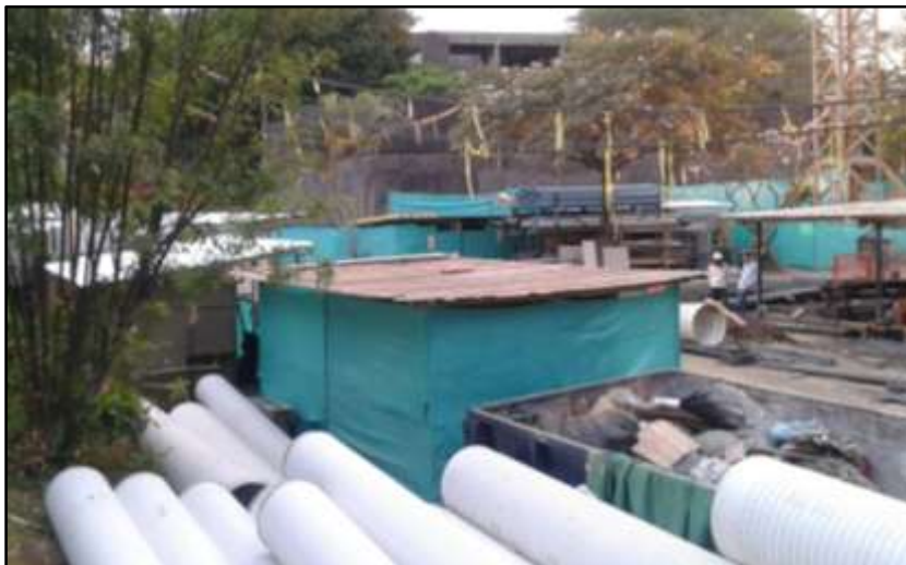
Figura 3-12. Acumulación de tuberías de construcción. Fuente: Autor, 2017.
