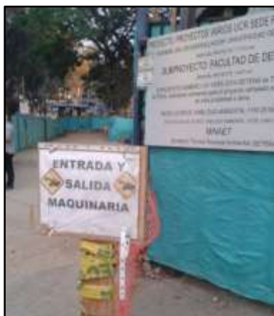
Figura 3-7. Presencia de señalización preventiva de entrada y salida de maquinaria. Fuente: Autor, 2017.
