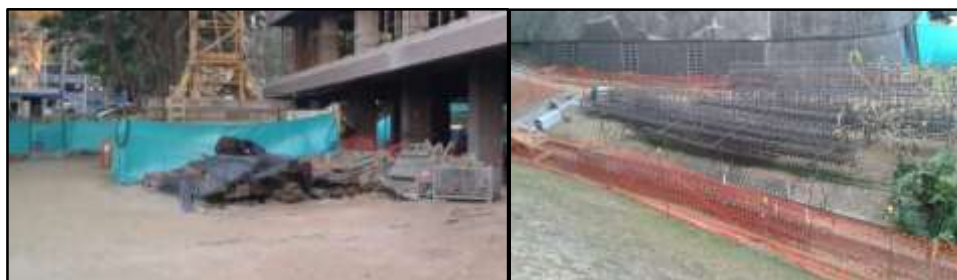
Figura 3-13. Acumulación de varillas de construcción. Fuente: Autor, 2017.
