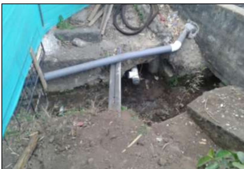
Figura 3-15. Cuneta para canalizar aguas pluviales. Fuente: Autor, 2017.
