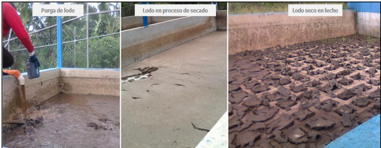
Figura 28. Deshidratación de lodo en lecho de secado
