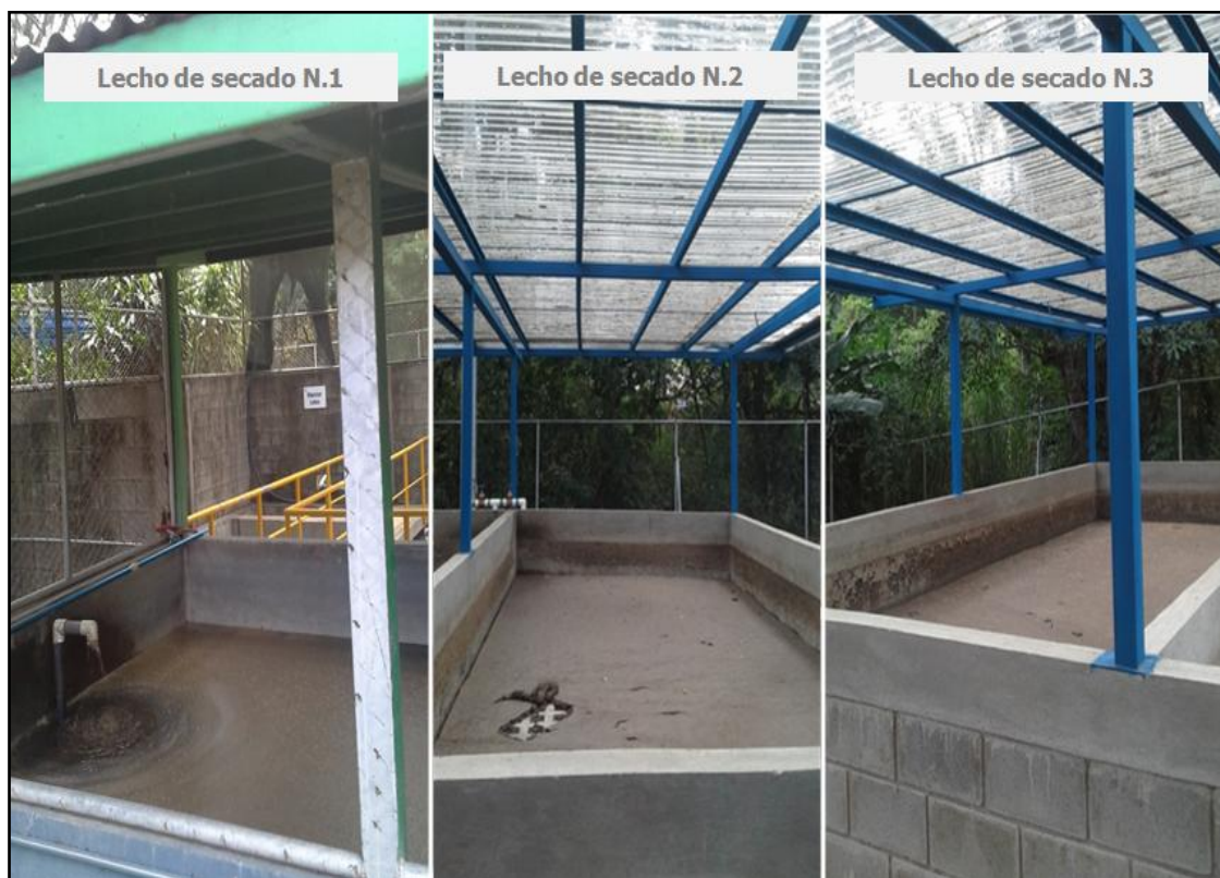
Figura 11. Tratamiento de lodos: Lechos de secado
