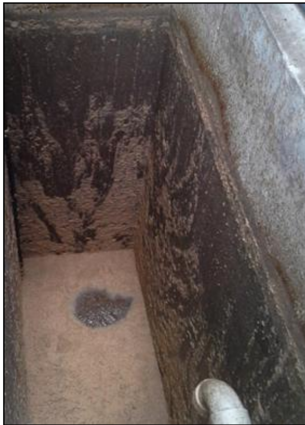
Figura 10. Tratamiento de lodos: Digester aerobio
