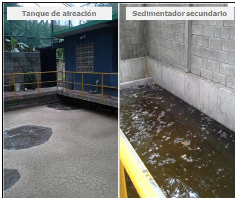
Figura 9. Tratamiento biológico: tanque de aireación y sedimentador secundario
