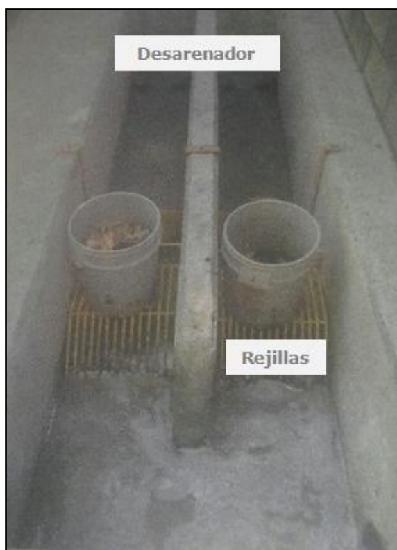
Figura 8. Pretratamiento: Rejillas y desarenador
