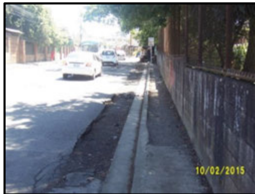
Figura 74. Ausencia total de acera
