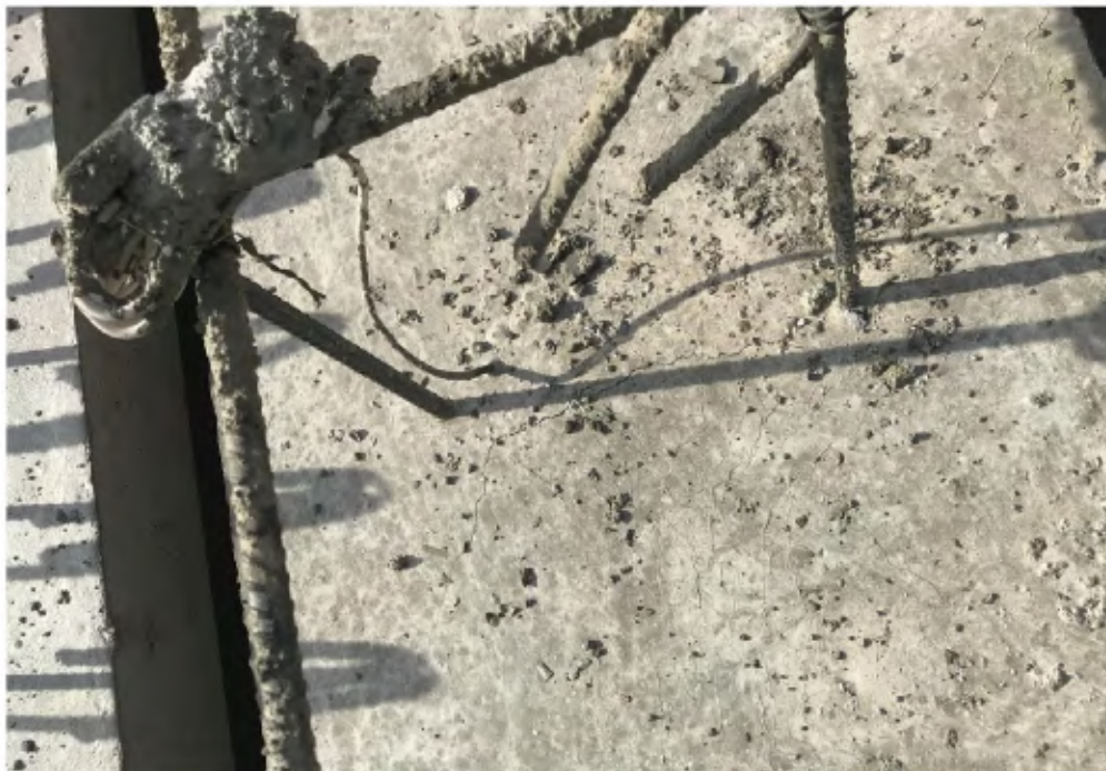
Figura 8.20. Viga choreada con sensor con concreto endurecido.
