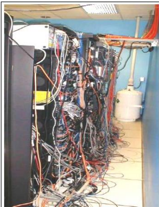
Ilustración 8-5 Ejemplo de instalación con inadecuado acomodo de cableado. (Hannaford, 2015).
