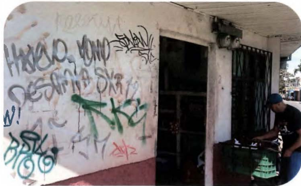
Foto 17: Casa en estado deteriorado Fuente: Elaboración Propia
