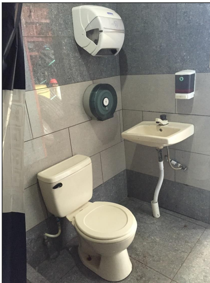
Figura 9. Condiciones de servicio sanitario
