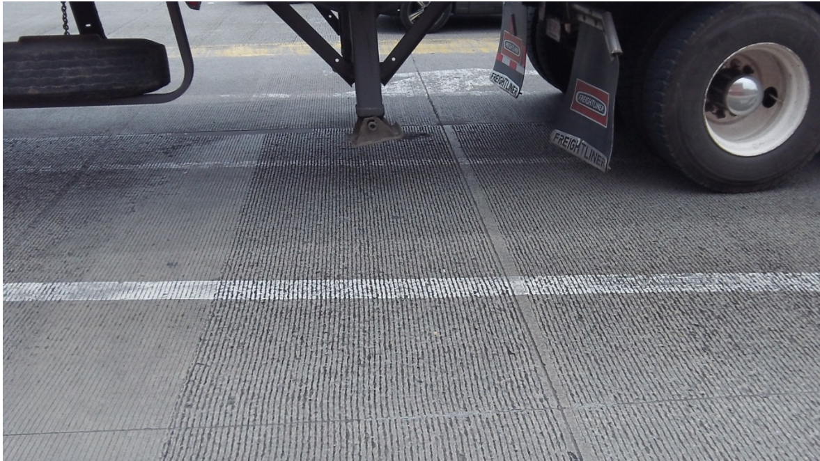
Figura 2.5 Deterioro en la superficie de las losas observado. (Fuente: Autor, auscultación visual de proyectos)
