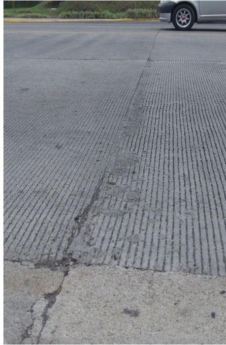
Figura 2.4 Deterioro en las juntas observado. (Fuente: Autor, auscultación visual de proyectos)
