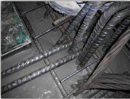
Figura 2.18. Uso de CAC, alta concentración de armadura Tomado de: www.hormigonesvicente.com
