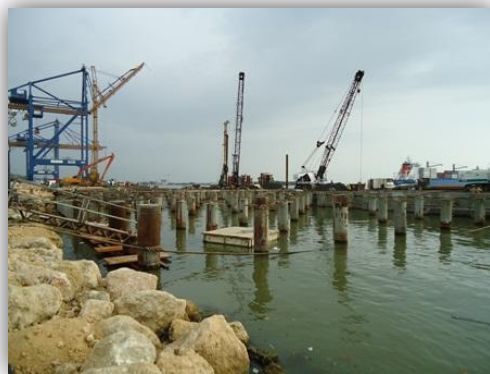
Figura 2.35. Pilotes de un muelle con problemas de corrosión
