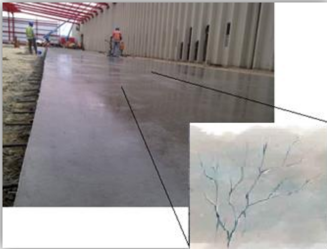
Figura 2.14. Las grietas por contracción plástica aparecen en la superficie del concreto a las pocas horas del colado, a veces muy pronto después y frecuentemente antes del allanado. A menudo no se notan hasta el siguiente día, pues se desarrollan luego de que los trabajadores han dejado la obra. Raramente perjudican la resistencia del concreto, pero de modo común forman un patrón, como las ramas de un árbol.
