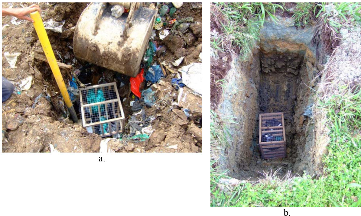
Figura 3.2 Cajas enterradas en los rellenos sanitarios de (a.)Los Mangos y (b.)Río Azul
