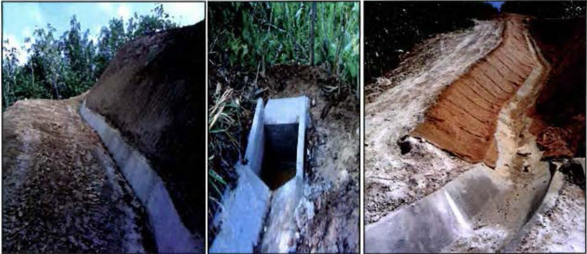
Figura 5.13. Construcción de cunetas y cajas de salida al pie de los taludes Fuente: ICE, 2011
