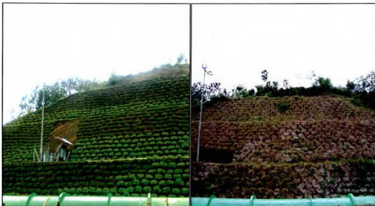
Figura 5.4 Talud en la tubería de alta presión, uso de pasto dulce para el control de erosión. Comparación en el tiempo de julio de 2011 a agosto de 2012 Fuente: ICE, 2012
