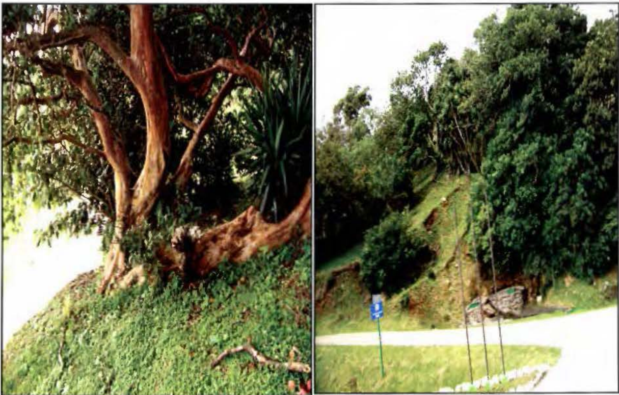
Figura 5.9 Talud con problemas de erosión Fuente: Silva, 2012
