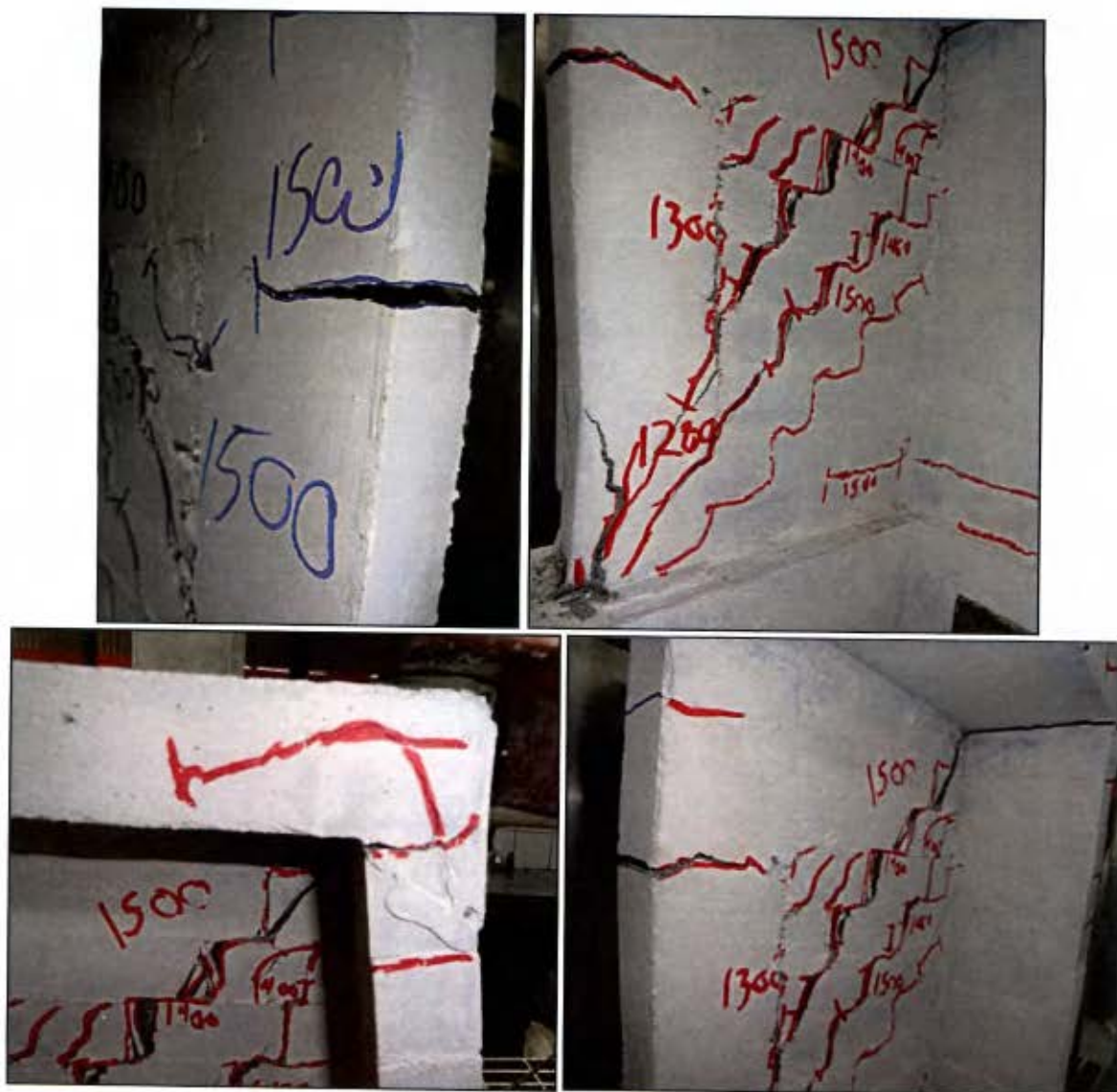
Figura 50. Detalles de la falla del Muro 3.
