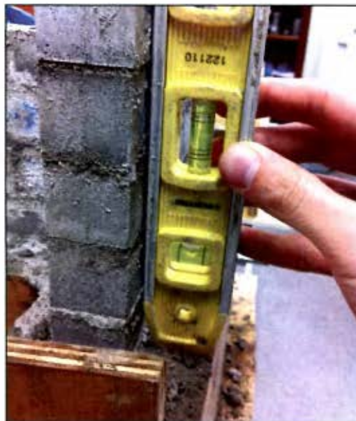
Figura 30. Alineamiento vertical de los muros.
