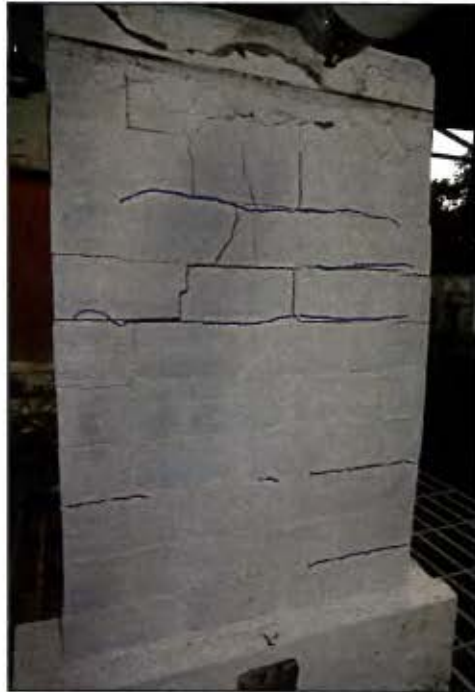
Figura 41. Muro 1 después de la falla (vista posterior).
