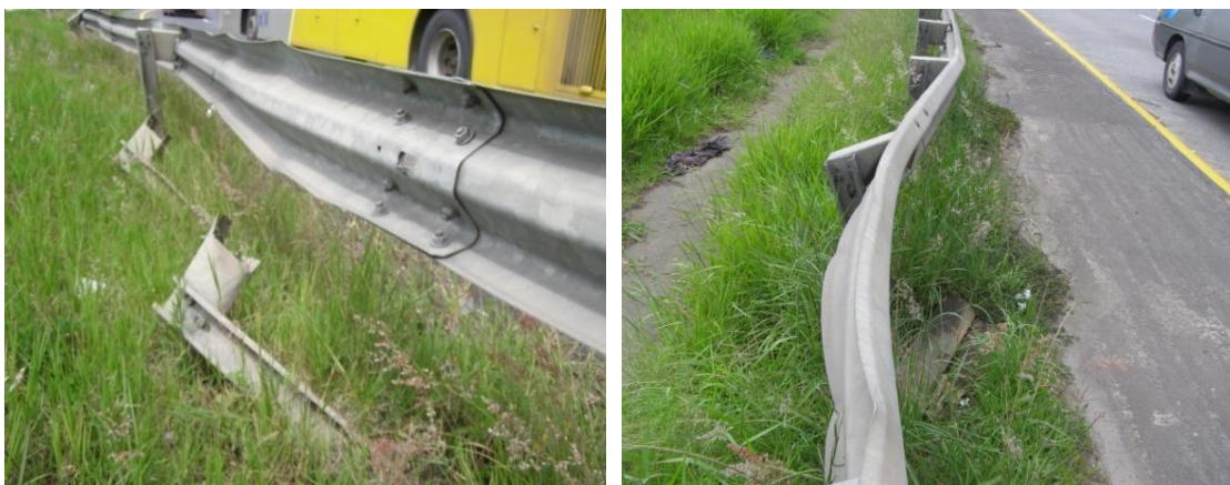
Fotografía 7.41 Barreras con un impacto que le generó falla total.
