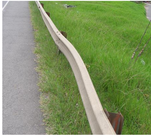
Fotografía 7.2 Estado regular encontrado en barreras semi-rígidas.
