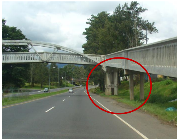
Fotografía 7.12 Estado grave de las condiciones para objetos fijos.
