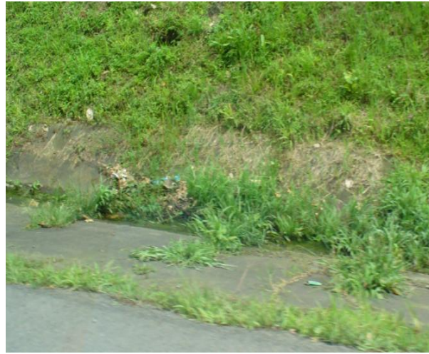
Fotografía 7.60 Cuneta obstruida por vegetación.
