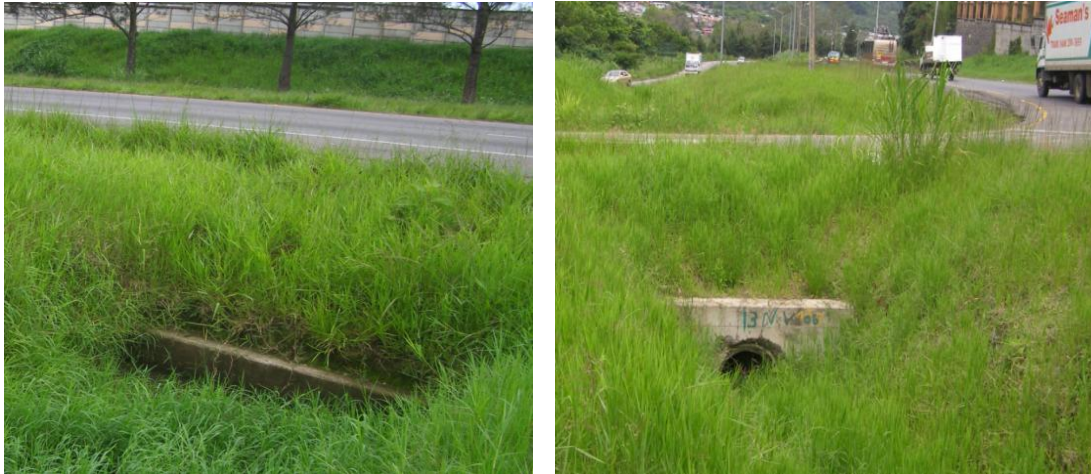
Fotografía 7.50 Pobre visibilidad de cunetas y alcantarillas por interferencia de la vegetación.
