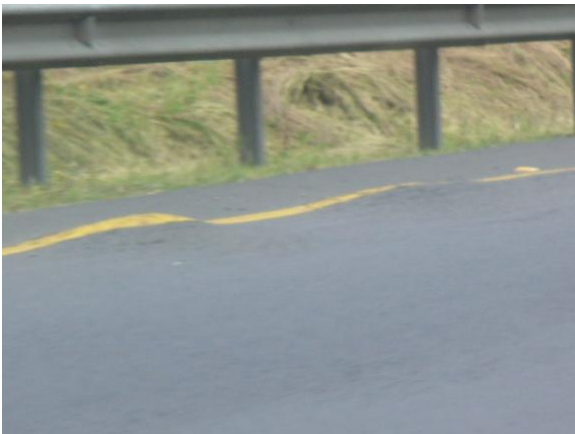
Fotografía 7.14 Deformación del pavimento en el tramo Ochoмого, sentido Cartago- San José.
