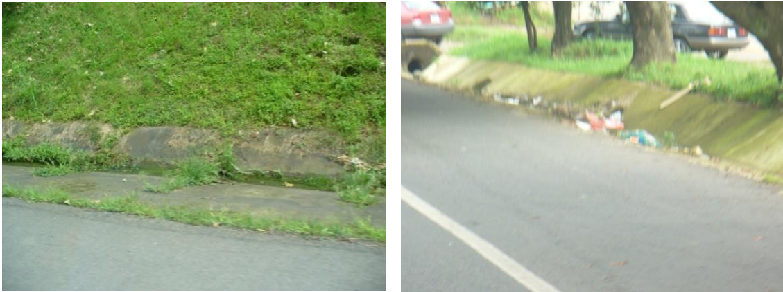
Fotografía 7.46 Presencia de vegetación y basura en las cunetas.
