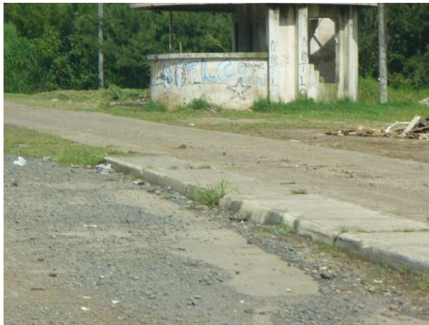
Fotografía 7.47 Presencia de material suelto en la cuneta.
