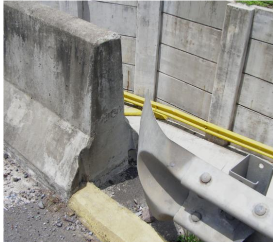
Fotografía 7.65 Barrera flexible con transición inadecuada a la protección de puente.
