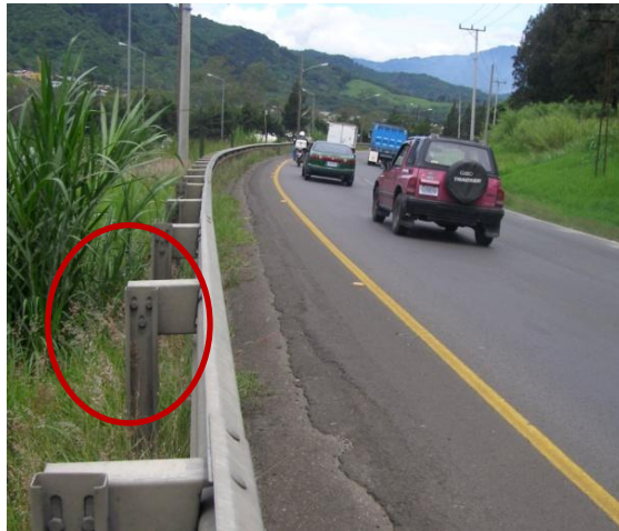
Fotografía 7.72 Sistema de contención con una inadecuada colocación.
