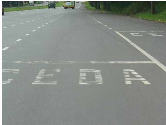
Fotografía 7.18 Desgaste de la pintura en la zona después del peaje.
