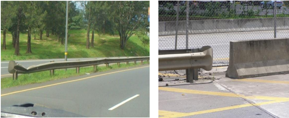
Fotografía 7.40 Barrera impactada y de longitud insuficiente en su transición al pretil del puente.
