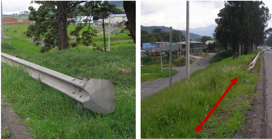
Fotografía 7.67 Barreras de contención con terminal cola de pez y longitud insuficiente.
