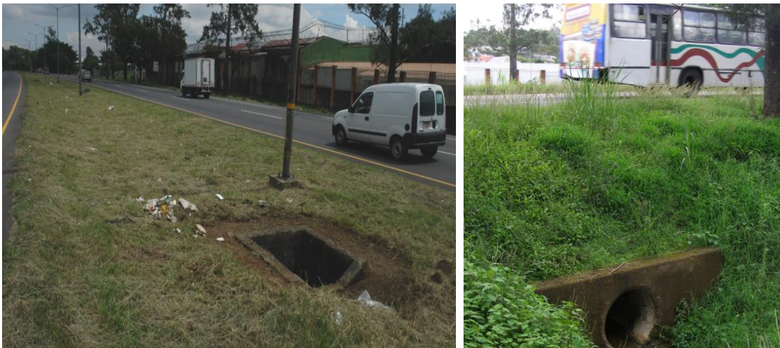
Fotografía 7.58 Alcantarillas sin protección.
