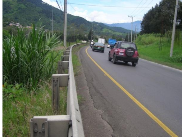
Fotografía 7.42 Colocación incorrecta de los postes del sistema de contención.
