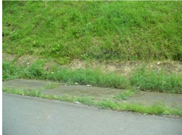
Fotografía 7.8 Cuneta con interferencia de vegetación.
