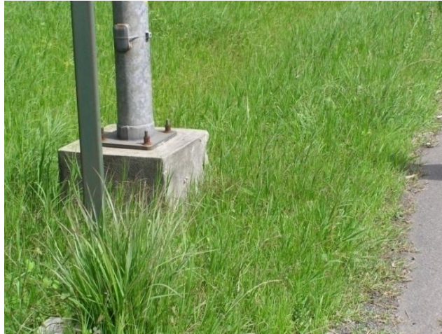
Fotografía 7.27 Base rígida de poste de iluminación colocado en la mediana y sin protección.
