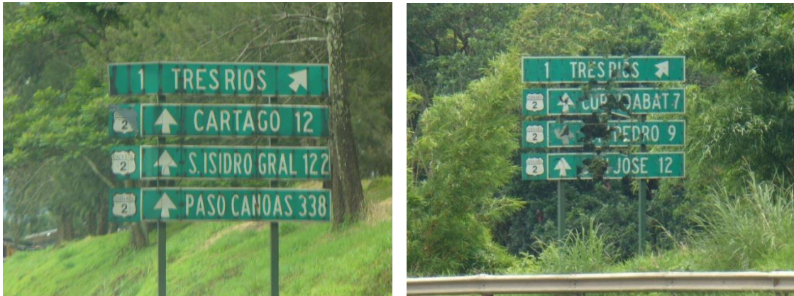
Fotografía 7.23 Mal estado del señalamiento vertical.
