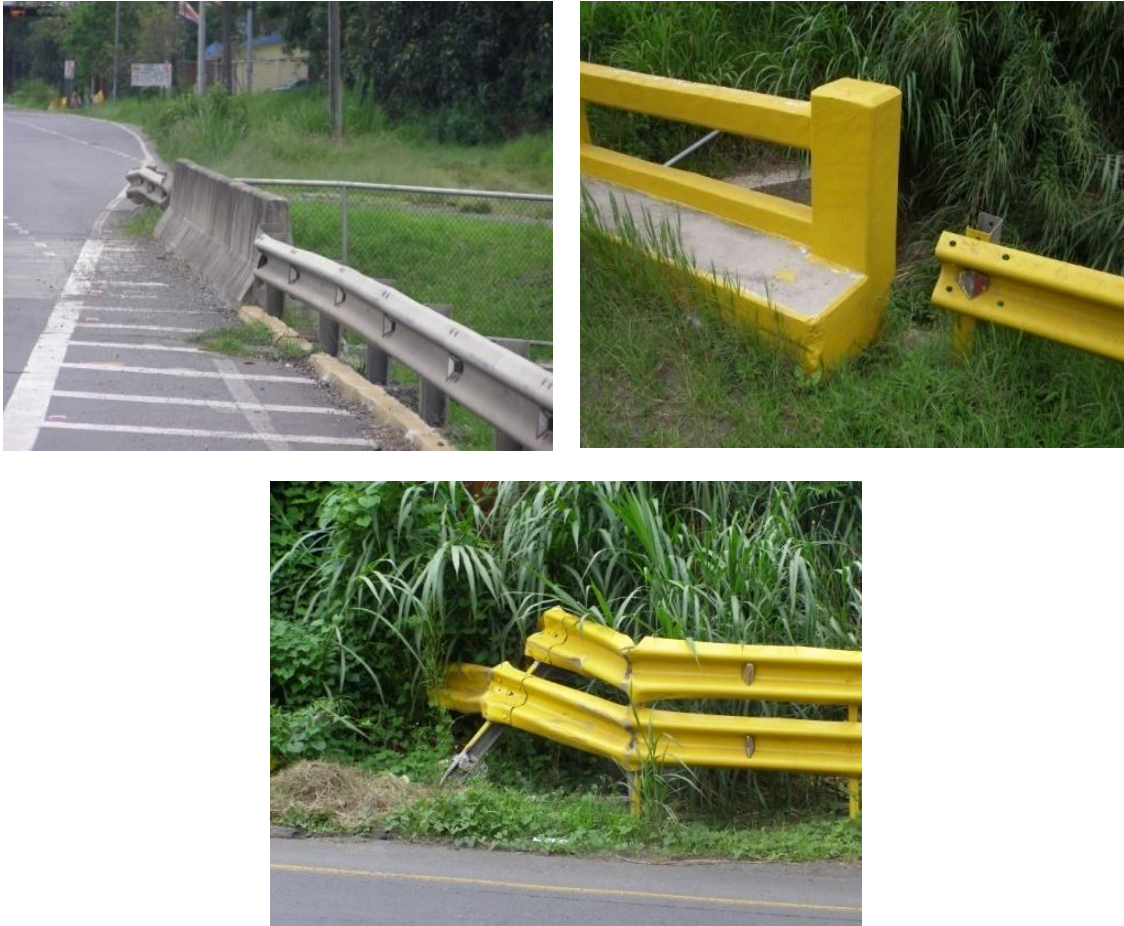
Fotografía 7.53 Problemas de las barreras en puentes.
