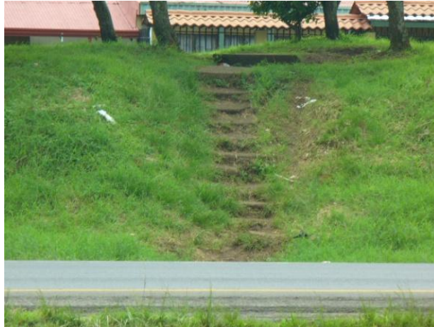
Fotografía 7.32 Accesos peatonales ilegales sin protección y ausencia de aceras.
