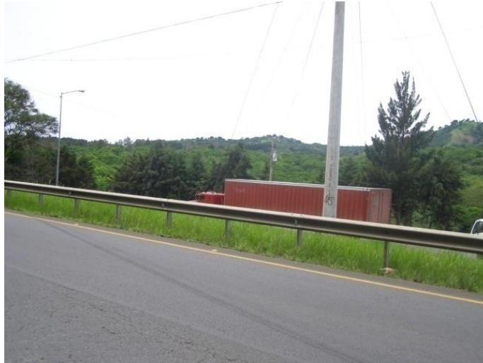
Fotografía 7.43 Nivel de contención insuficiente para la velocidad y condiciones topográficas de la zona.
