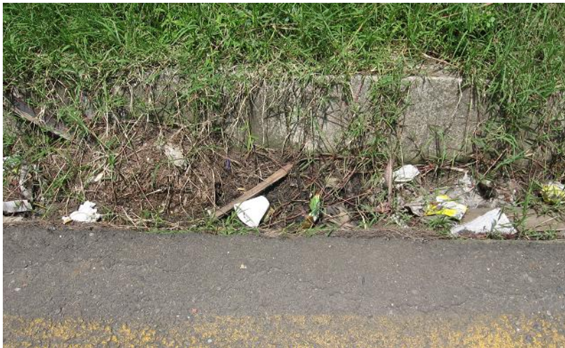
Fotografía 7.9 Cuneta afectada completamente por la vegetación.
