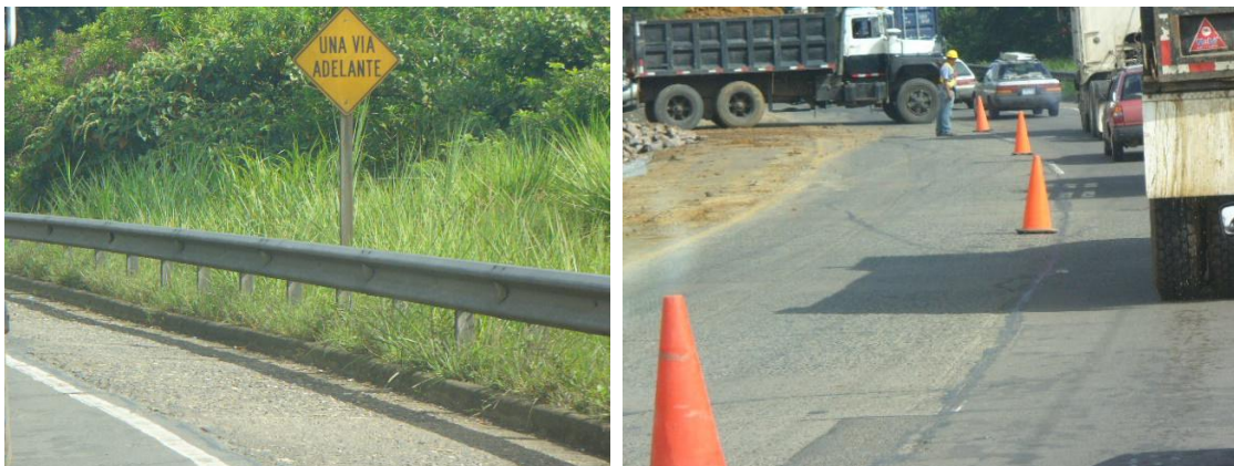
Fotografía 7.52 Señalización adecuada relativa a trabajos en la vía y uso inadecuado e insuficiente de dispositivos de seguridad.
