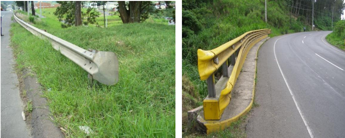
Fotografía 7.38 Barreras flexibles con terminal cola de pez.
