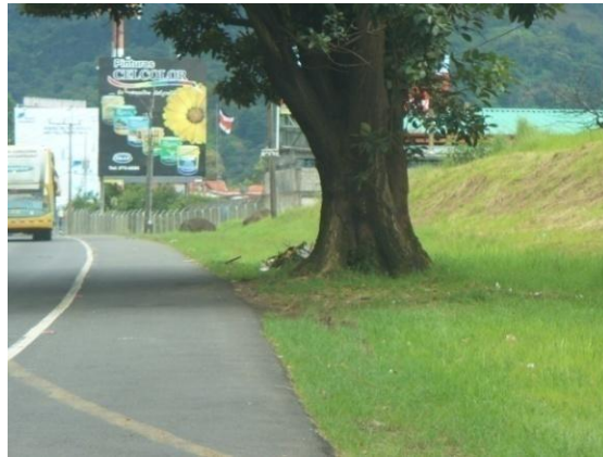
Fotografía 7.45 Presencia de árboles en la orilla de la vía que puede provocar impactos y agrietamientos por raíces.
