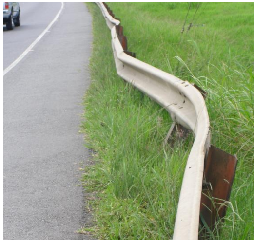
Fotografía 7.64 Barrera flexible impactada.
