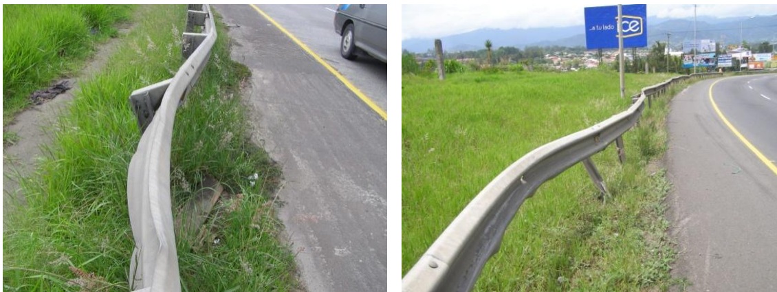
Fotografía 7.39 Barreras impactadas que no han sido sustituidas.
