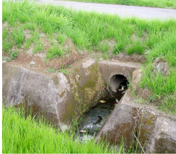
Fotografía 7.69 Cuneta no traspasable sin protección.
