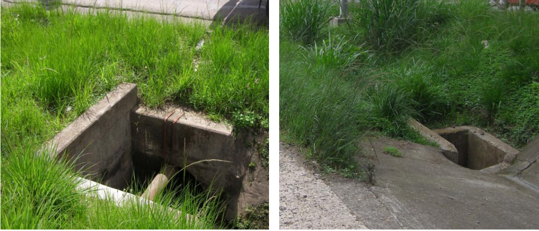
Fotografía 7.48 Alcantarillas sin protección.
