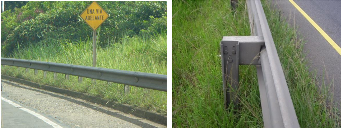
Fotografía 7.5 Estado de afectación regular por parte de la vegetación.
