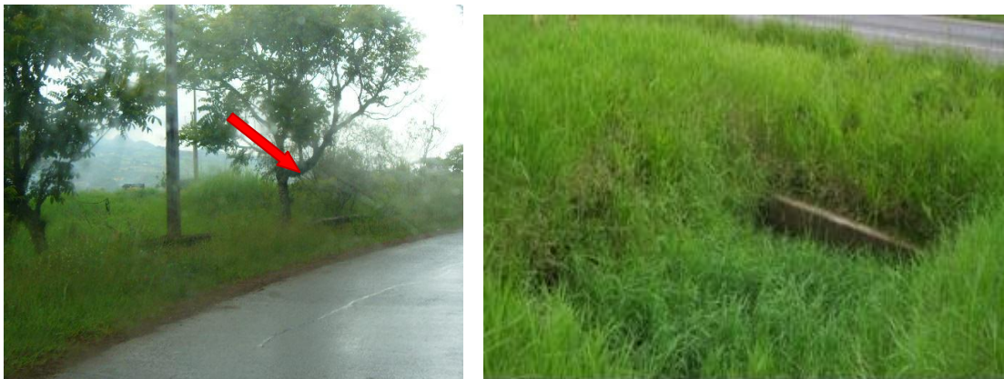
Fotografía 7.6 Estado malo de la afectación por parte de la vegetación.
