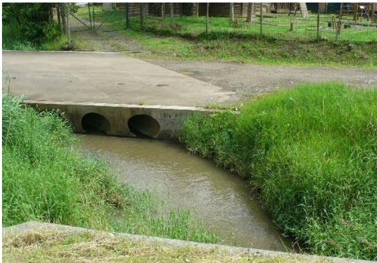
Fotografía 7.28 Cuneta de profundidad considerable sin protección.
