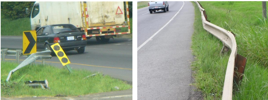
Fotografía 7.3 Estado malo en barreras semi-rígidas.
