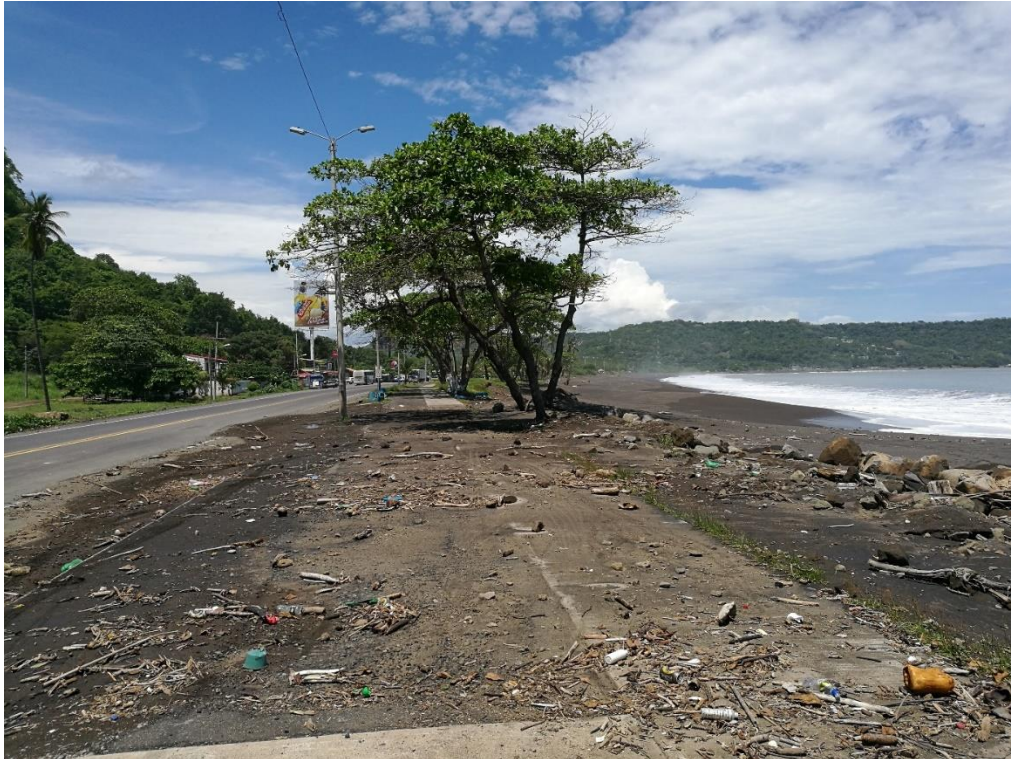
Figura 1.2. Playa Caldera, evidencia de entrada del mar a la Ruta 23.
