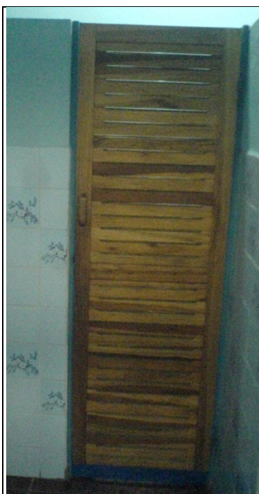
Figura 4.16 Puerta de baño sin el ancho requerido, pero con agarradera tipo barra. Fuente: El Autor
