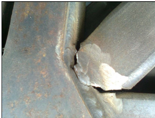
Figura 6.12. Falla en la soldadura del elemento diagonal central del espécimen C1-1.
