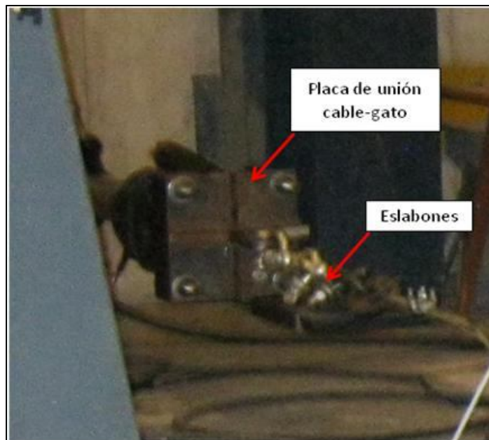
Figura H.5. Detalle de la unión cable-gato. La placa mostrada falló.
