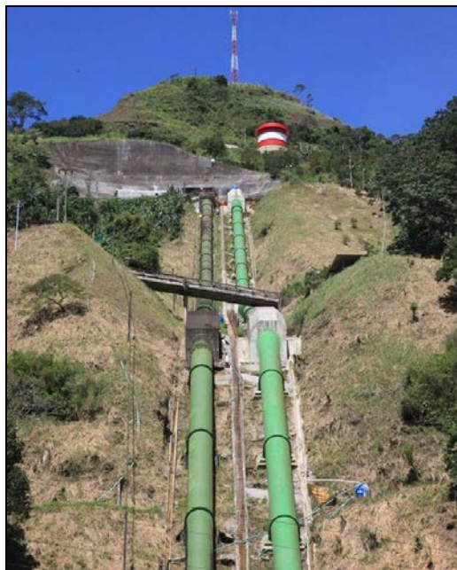
Figura 31. Tuberías de presión y nuevo tanque de oscilación de la P.H. Cachí
