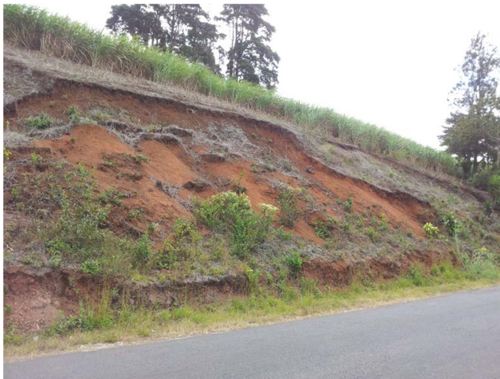
Figura 3.2 Fotografía de un talud con problemas de erosión y movimiento de masa en la calle entre los sitios de muestreo 1 y 2
