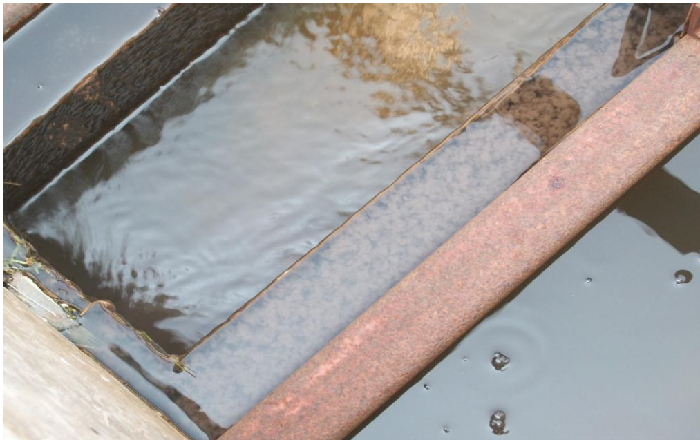
Figura 3.3.3 Lodos dispersos en la canaleta del clarificador
