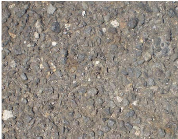
Figura 3.8: Desprendimiento de agregados
