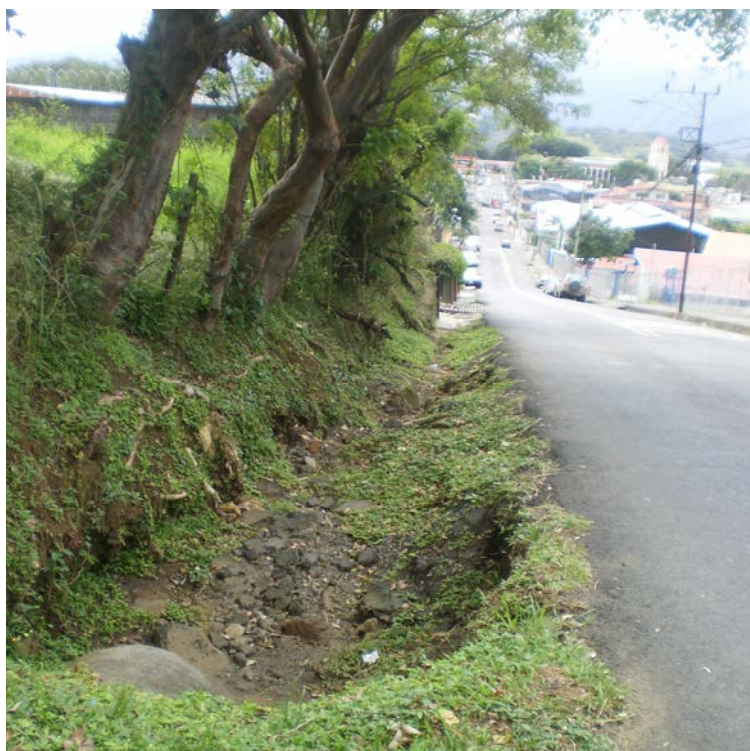
Figura 3.10: Ausencia de espaldón
