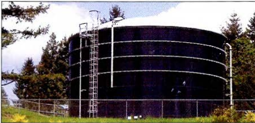
Figura 7.2. Tanque metálico de acero vitrificado.
