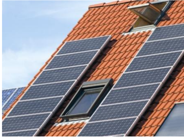
Figura 4.11 Paneles fotovoltaicos para el aprovechamiento del sol.
