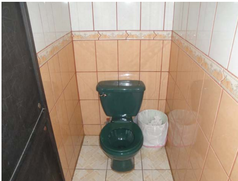
Figura 3.11. Inodoro colocado al centro y sin agarraderas
