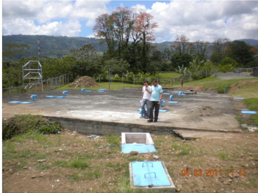
Figura 2.7. Fotografía del tanque del sistema F.A.F.A. del la urbanización El Mora.
